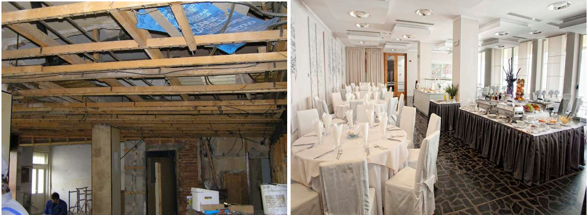
Slika 60: Restoran hotela Jadran tijekom (lijevo) i nakon rekonstrukcije (desno) (izvori: Fotodokumentacija izvođenja radova na hotelu Jadran, vlasništvo "Studia Remik" d.o.o., 2004./2005. godina, Rijeka i internet stranica hotela Jadran https://www.jadran-hoteli.hr/jadran , pristup 09.05.2021.)
