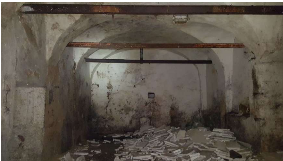
Slika 29: Ležni podrum - vidljivi dijelovi izolacije od pluta koji su otpali sa konstrukcije
