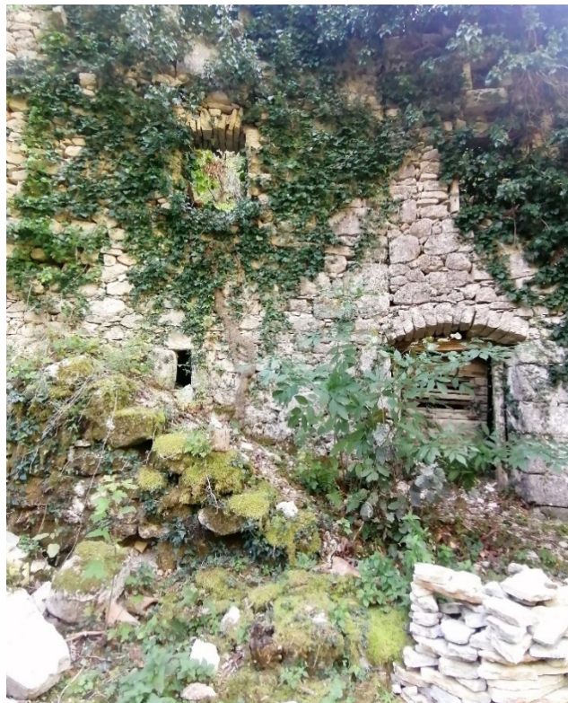
Slika 41: Ruševine stambenog objekta obrasle bršljanom s kamenim ertama i kamenim lukovima te drvenim ulaznim vratima s horizontalnim ukladama
