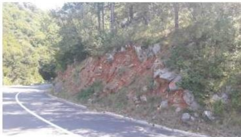
Slika 115. Predmetna kosina u sklopu inženjerskog bloka 1
