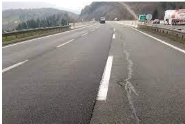
Slika 8: Oštećenje kolnika tipa uzdužna pukotina [10]
