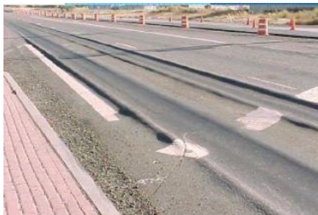
Slika 7: Oštećenje kolnika tipa kolotraženje [2]
