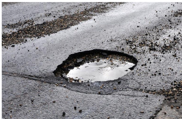
Slika 11: Oštećenje kolnika tipa udarna rupa [12]
