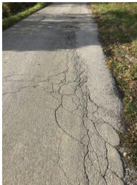
Slika 9: Oštećenje kolnika tipa blok pukotine [11]
