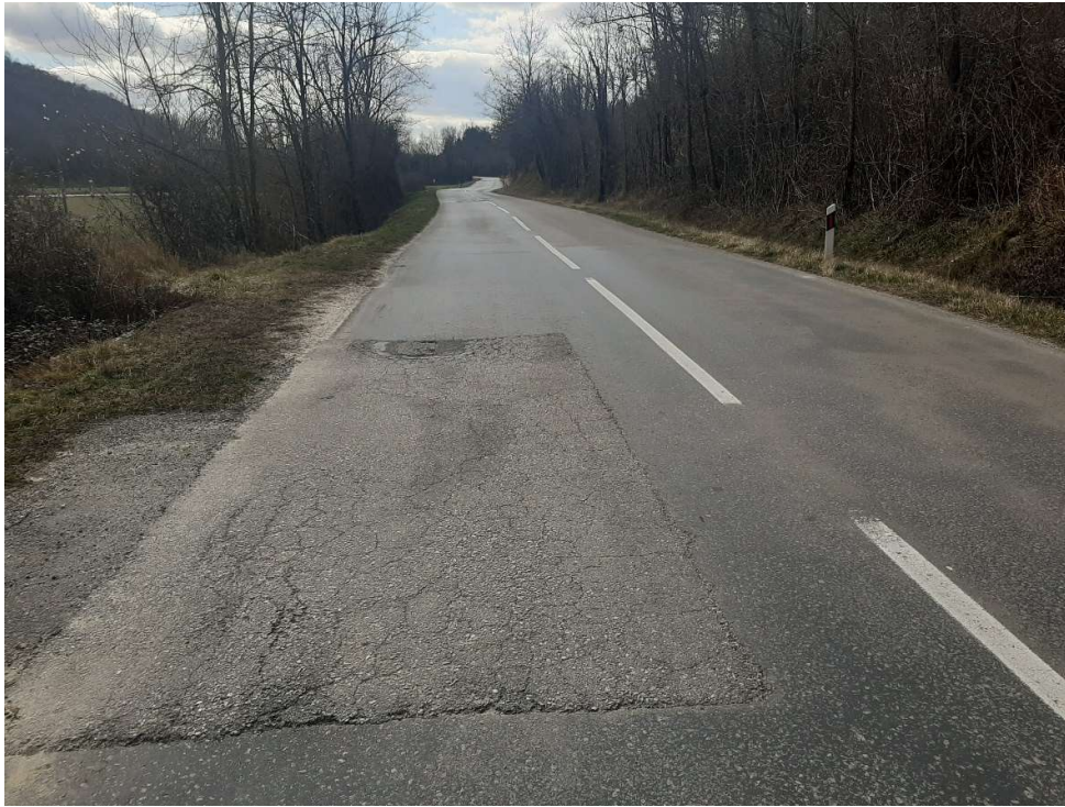
Slika 33: Iznožavanje veziva visokog stupnja oštećenja [foto autor]
