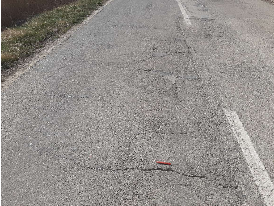
Slika 20: Poprečna pukotina visokog stupnja oštećenja [foto autor]
