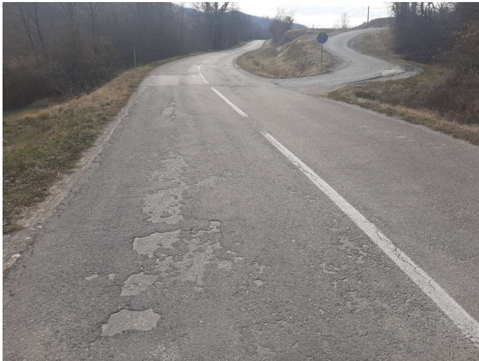
Slika 28: Odvajanje završnog sloja visokog stupnja oštećenja [foto autor]
