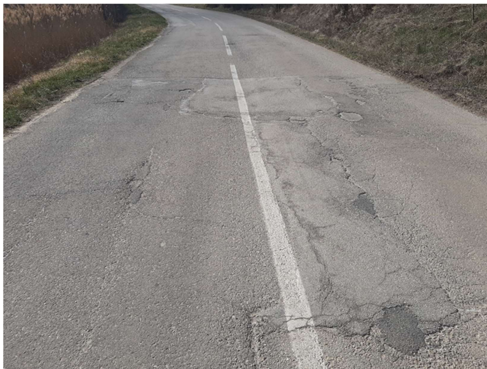
Slika 32: Popravci visokog stupnja oštećenja [foto autor]
