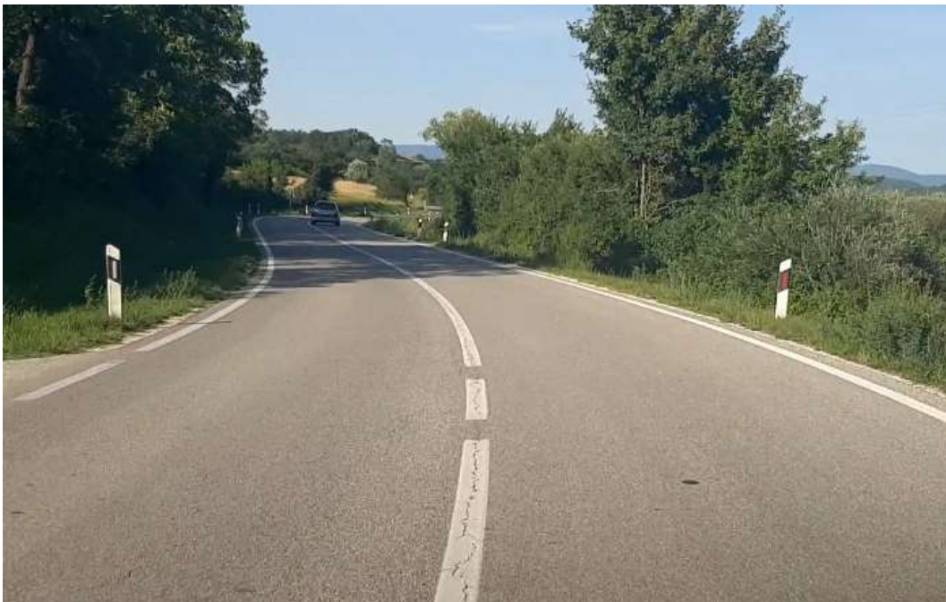
Slika 36: Uzdužna pukotina umjerenog stupnja oštećenja (Pazinski Novaki-Cerovlje) [foto autor]
