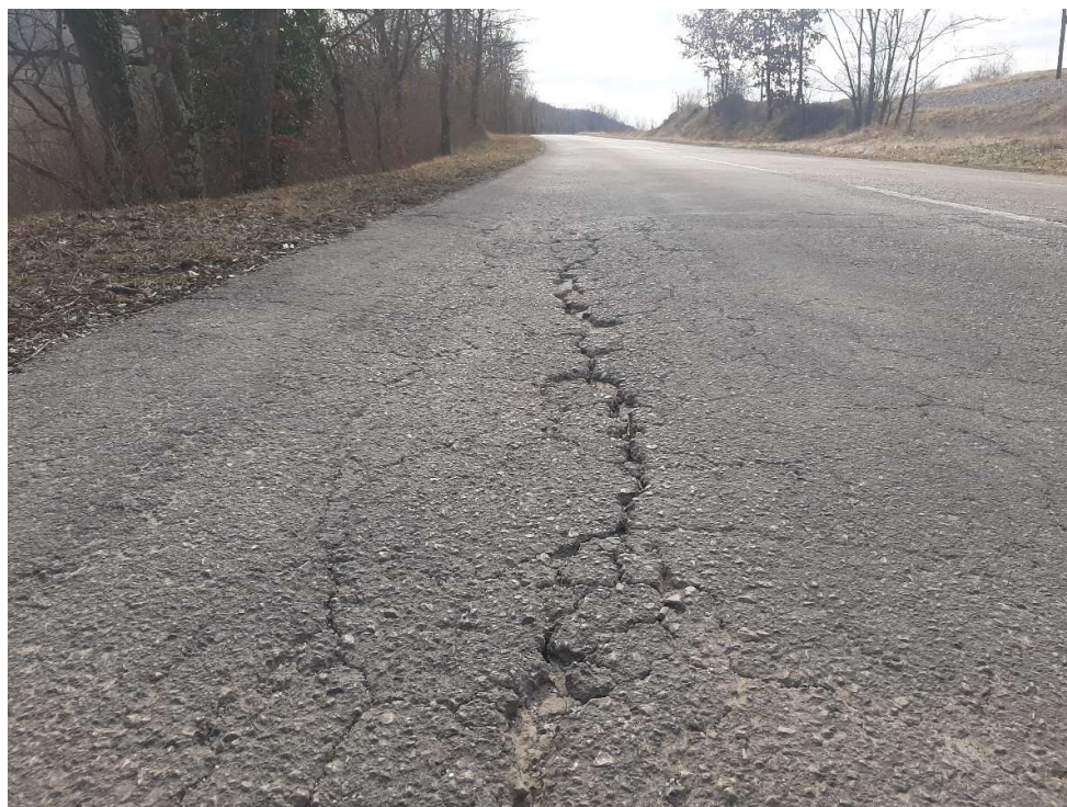
Slika 23: Uzdužna pukotina visokog stupnja oštećenja [foto autor]
