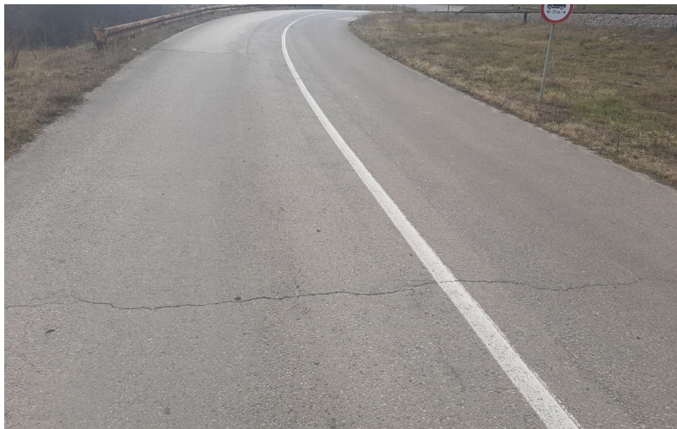
Slika 19: Poprečna pukotina umjerenog stupnja oštećenja [foto autor]
