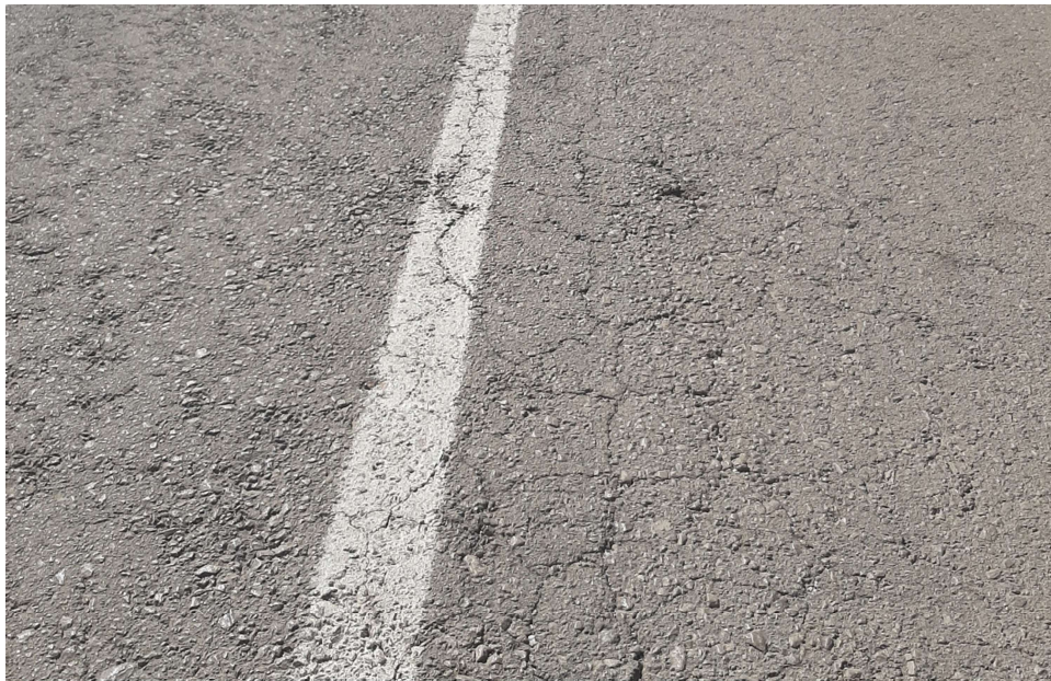
Slika 15: Mrežasta pukotina niskog stupnja oštećenja [foto autor]
