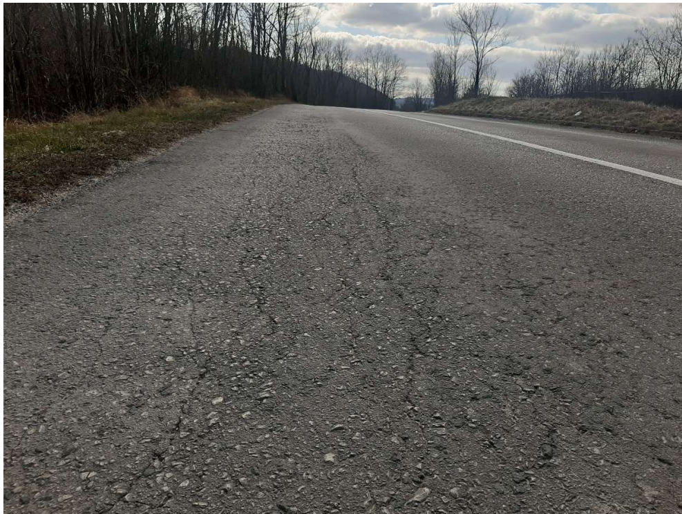
Slika 21: Uzdužna pukotina niskog stupnja oštećenja [foto autor]
