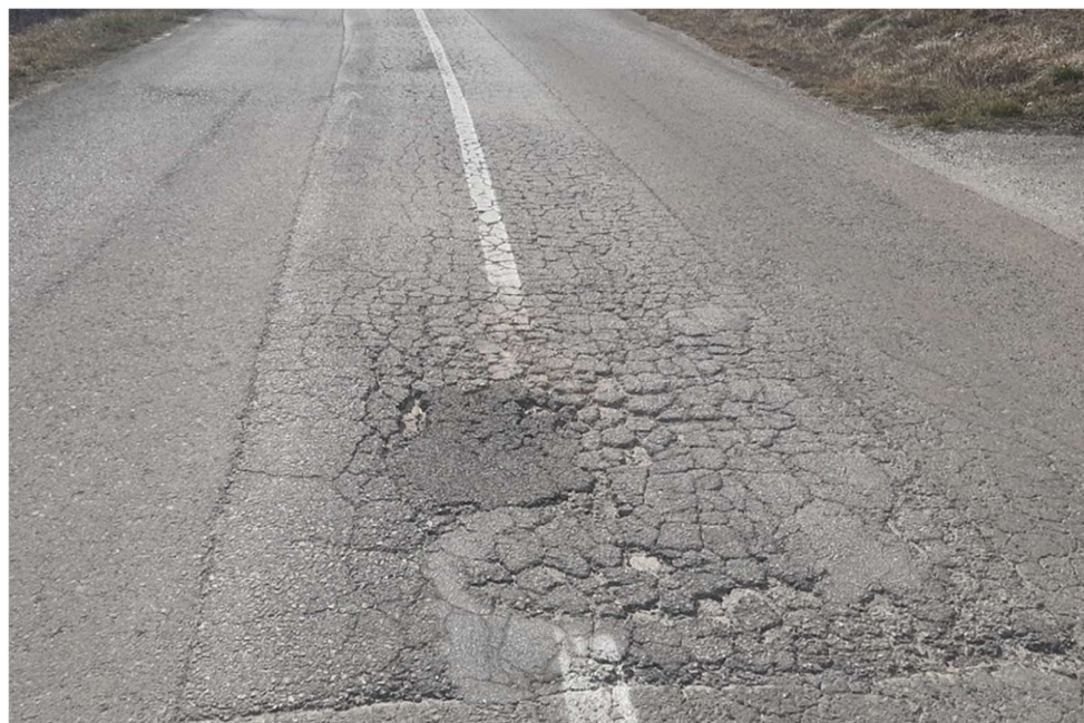
Slika 17: Mrežasta pukotina visokog stupnja oštećenja [foto autor]
