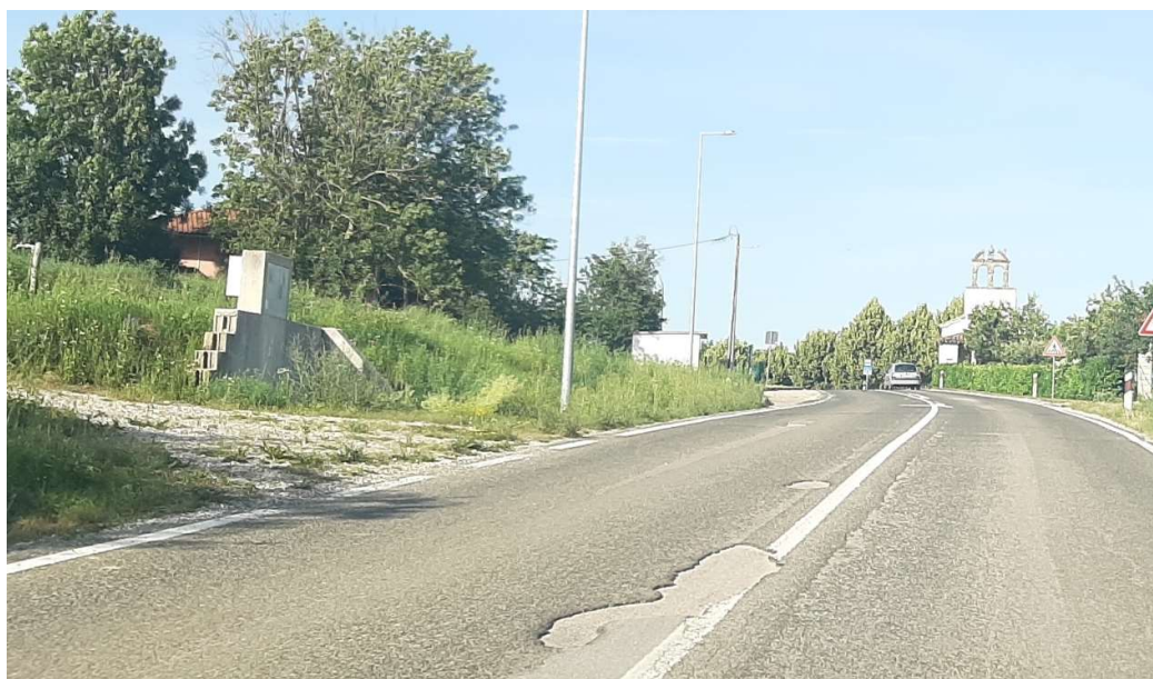
Slika 37: Odvajanje završnog sloja visokog stupnja oštećenja (Pazinski Novaki-Cerovlje) [foto autor]
