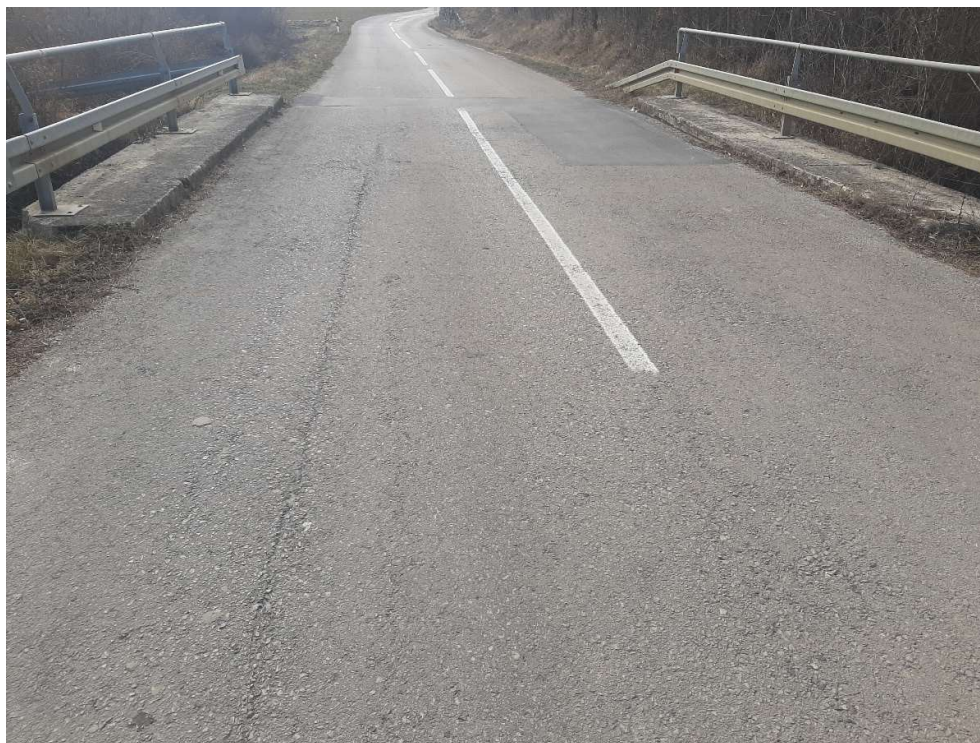
Slika 22: Uzdužna pukotina umjerenog stupnja oštećenja [foto autor]
