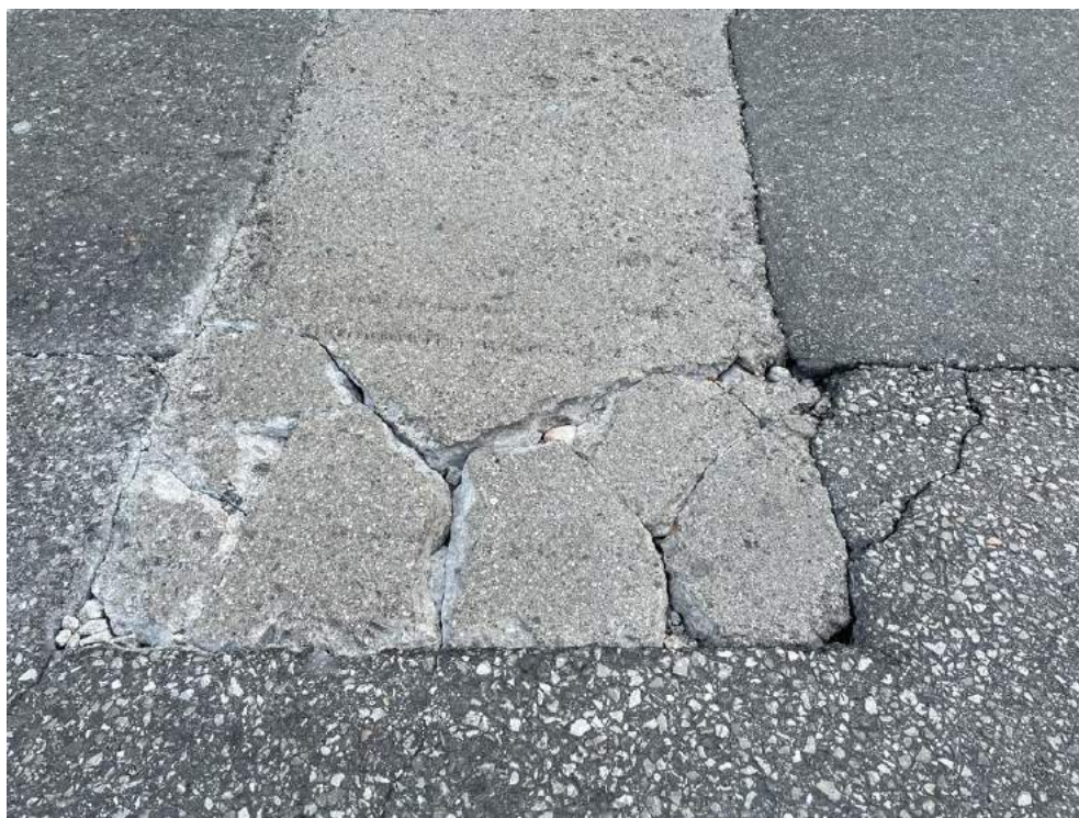
Slika 73: Oštećenje postojećeg popravka (visoki stupanj oštećenja)
