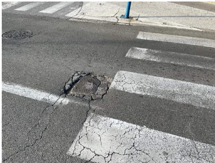
Slika 27: Pukotine i udubljenje oko popravka oštećenja (visok stupanj oštećenja)
