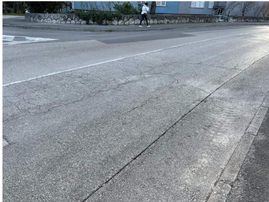
Slika 82: Mrežaste pukotine (visoki stupanj oštećenja)
