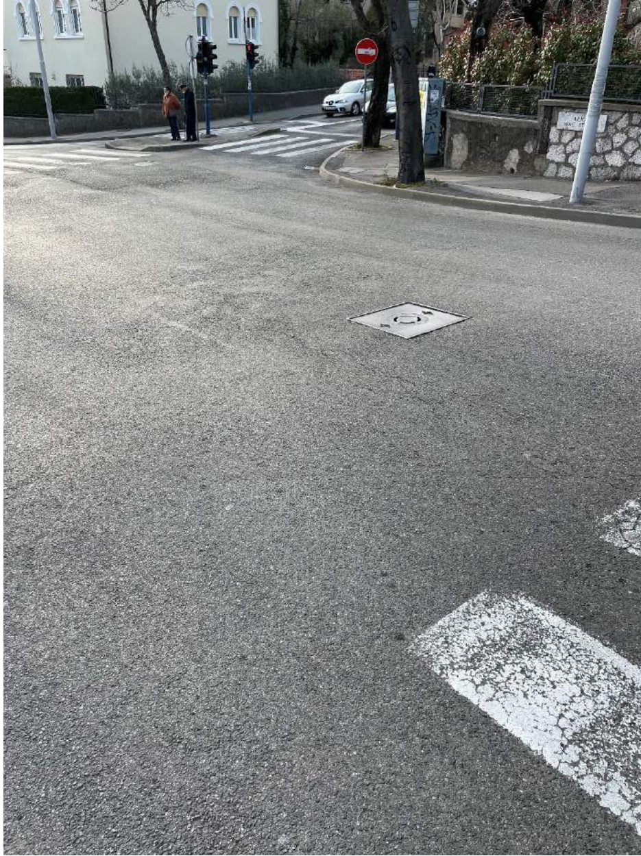
Slika 35: Mrežasta pukotina (umjeren stupanj oštećenja)
