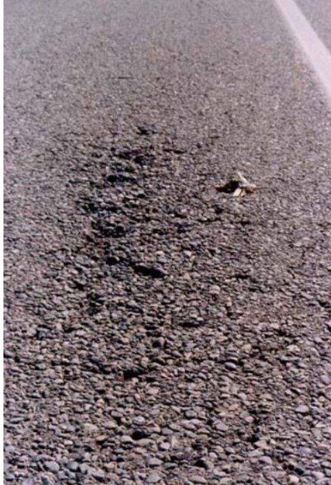
Slika 20: Visoki stupanj oštećenja (krunjenje) [12]
