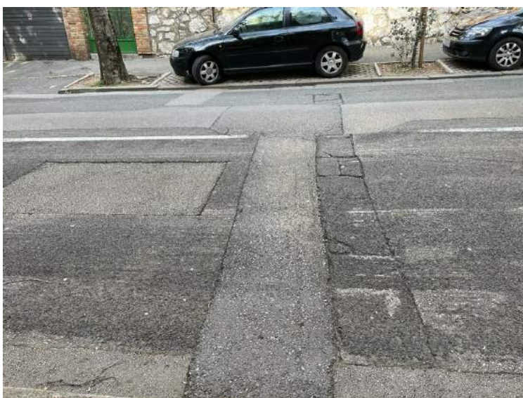
Slika 61: Popravci (visoki stupanj oštećenja)
