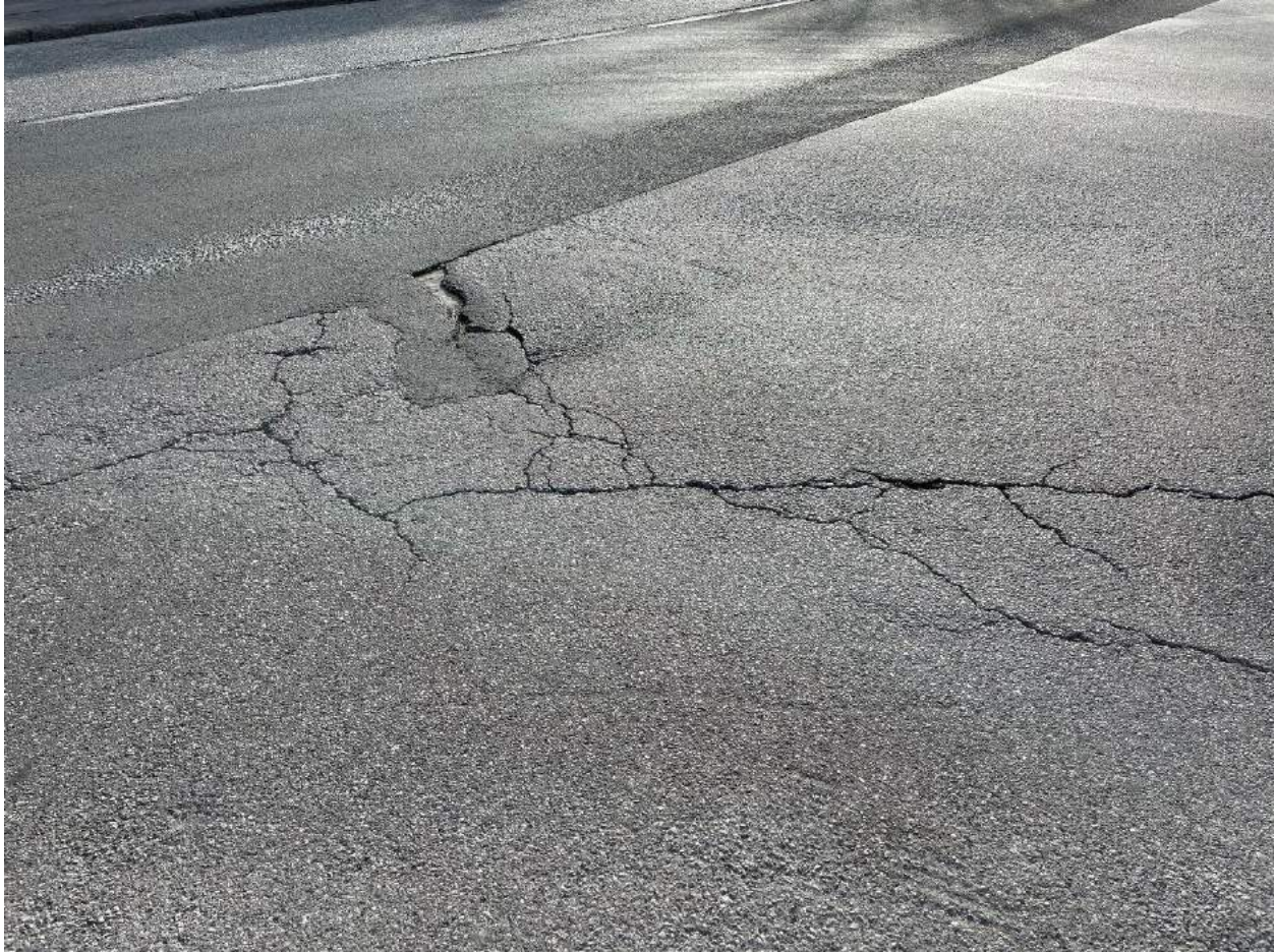
Slika 37: Mrežaste pukotine i odlamanje završnog sloja asfalta na području ulegnuća (visoki stupanj oštećenja)
