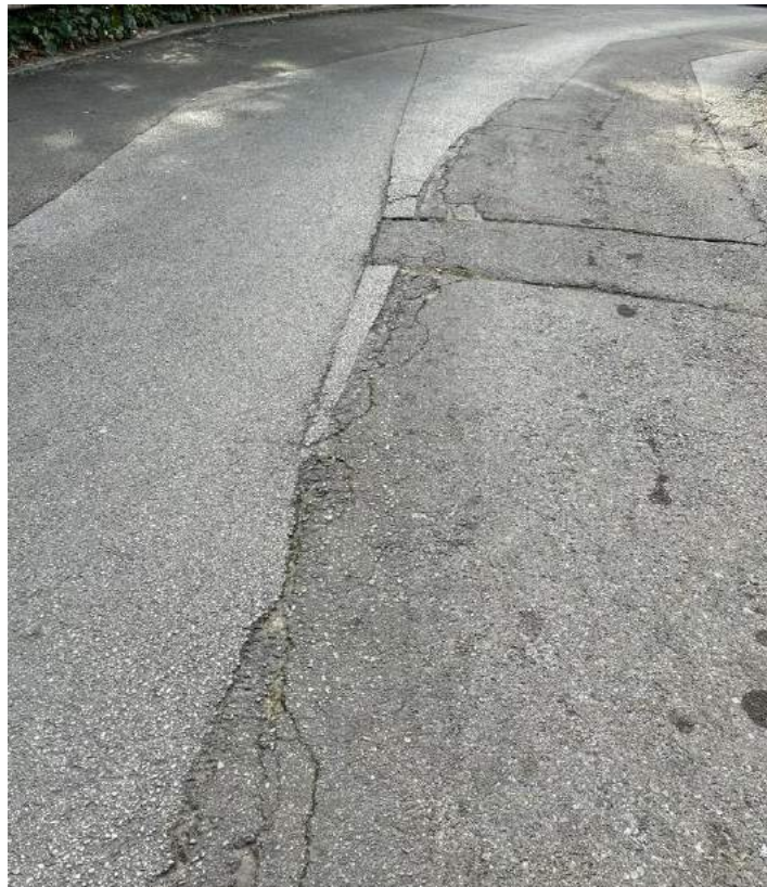
Slika 102: Popravci i uzdužne pukotine (visoki stupanj oštećenja)
