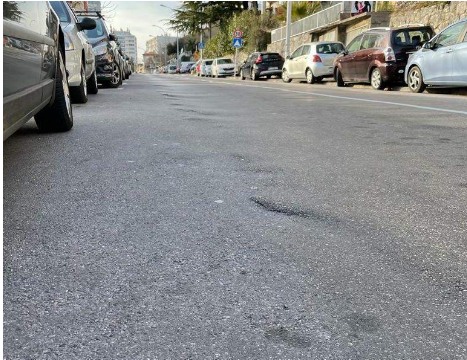
Slika 87 : Kolotrazi (visoki stupanj oštećenja)
