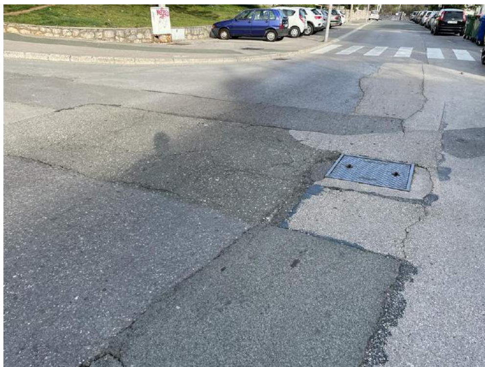
Slika 75: Popravci (visoki stupanj oštećenja)
