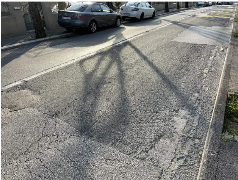
Slika 95: Mrežaste pukotine (visoki stupanj oštećenja)
