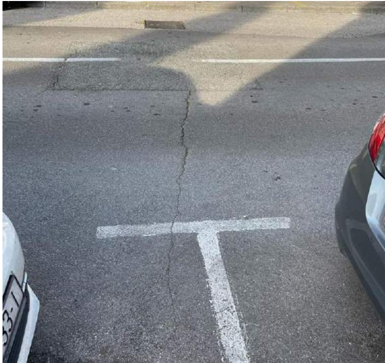
Slika 88: Poprečna pukotina (visoki stupanj oštećenja)
