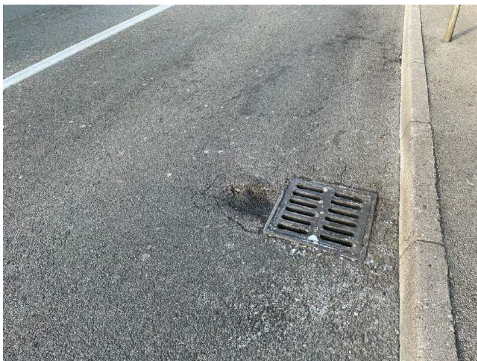
Slika 54: Odlamanje završnog sloja asfalta (visok stupanj oštećenja)
