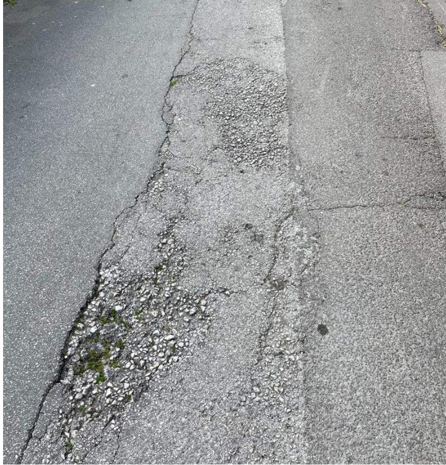
Slika 108: Krunjenje asfalta (visoki stupanj oštećenja)
