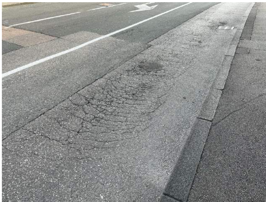
Slika 29: Pukotine u udubljenjima asfalta (visoki stupanj oštećenja)
