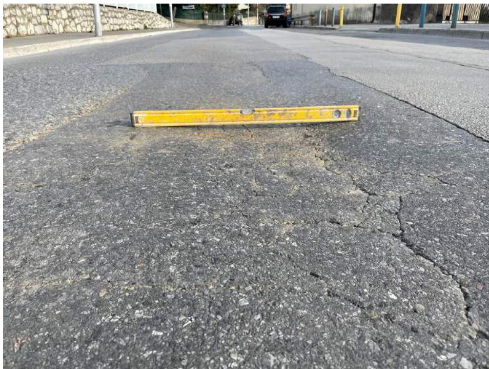
Slika 72: Mrežaste pukotine na području ulegnuća (visoki stupanj oštećenja)
