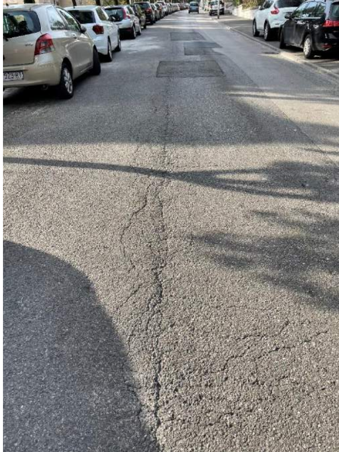
Slika 66: Uzdužna pukotina i popravci (umjeren stupanj oštećenja)
