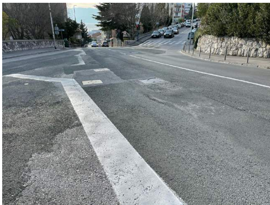
Slika 28: Krunjenje asfaltnog sloja (nizak stupanj oštećenja)
