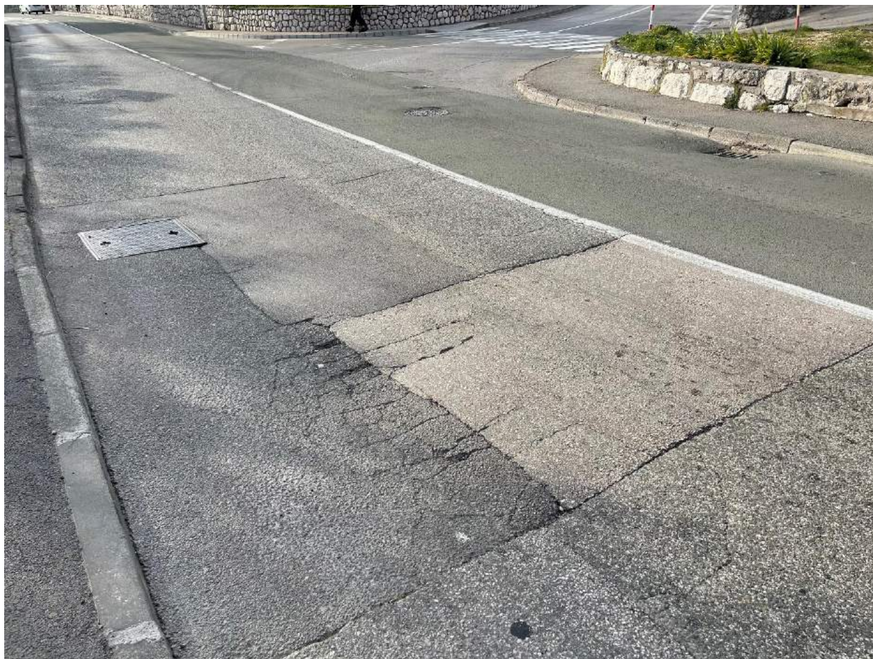
Slika 38: Popravci i mrežaste pukotine na području ulegnuća (visoki stupanj oštećenja)
