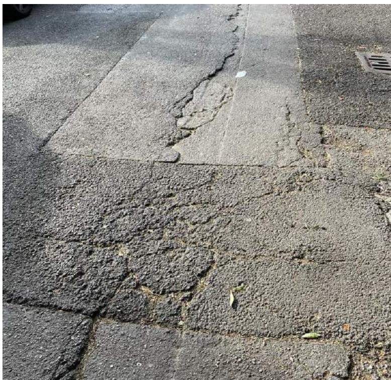
Slika 107: mrežaste pukotine (visoki stupanj oštećenja)
