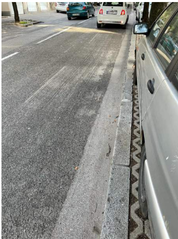
Slika 60: Kolotrazi (umjeren stupanj oštećenja)
