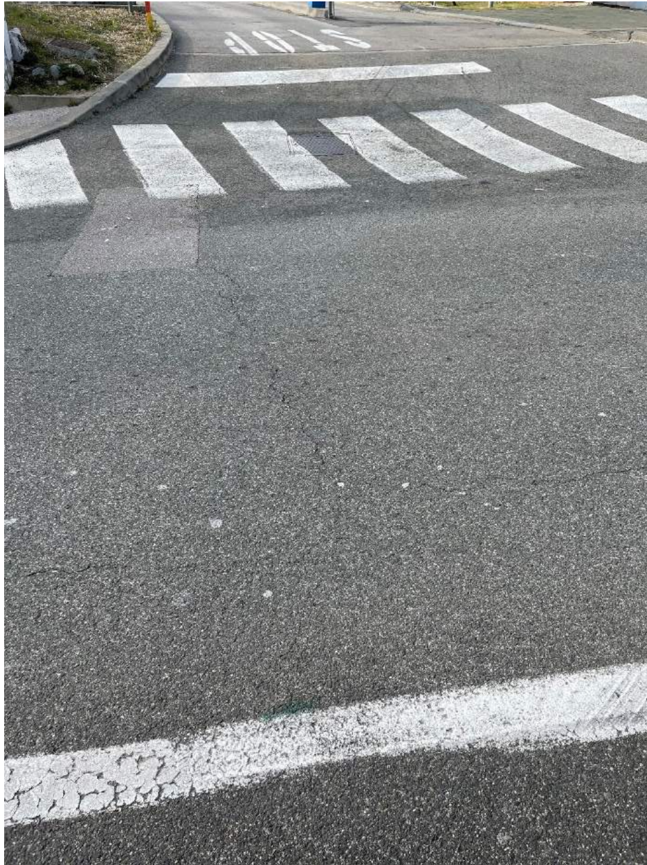
Slika 36: Popravak i poprečna pukotina (niski stupanj oštećenja)
