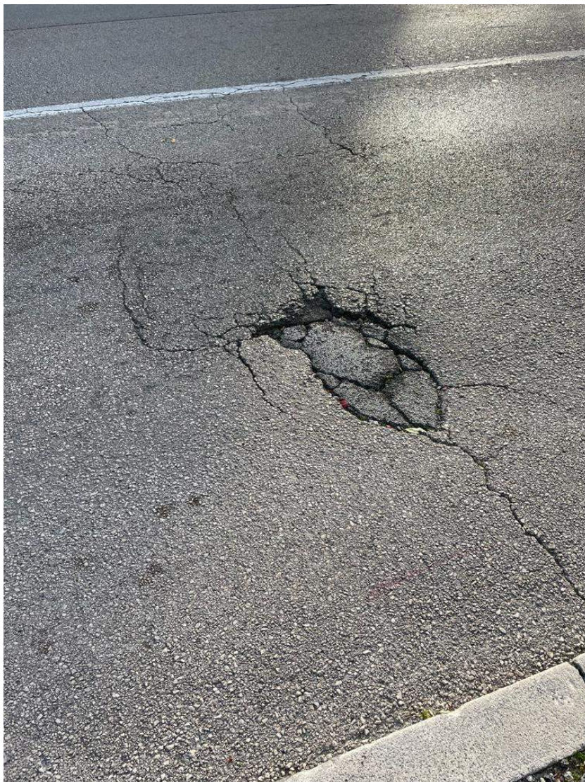
Slika 84: Oštećenje postojećeg popravka (visoki stupanj oštećenja)
