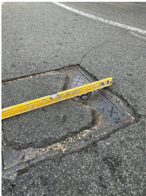
Slika 58: Ulegnuće šahte (visoki stupanj oštećenja)
