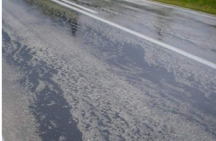
Slika 19: Visok stupanj oštećenja izbijanja bitumenskog veziva [12]
