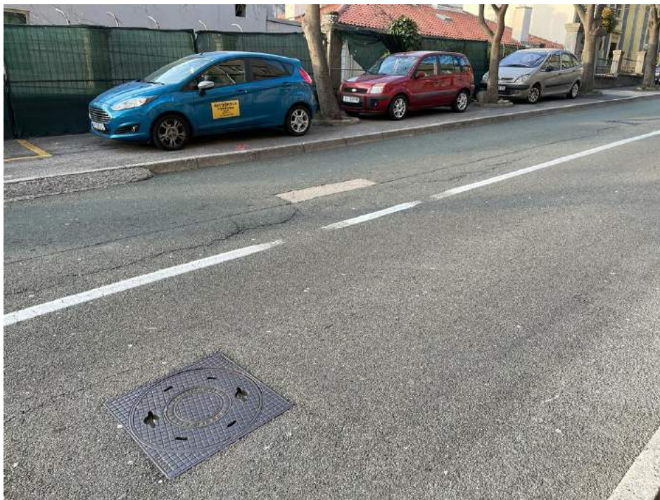
Slika 53: Uzdužne pukotine (umjeren stupanj oštećenja)
