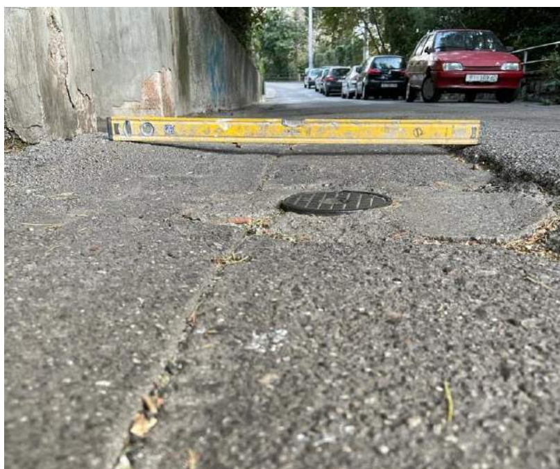
Slika 105: Ulegnuće asfalta (visoki stupanj oštećenja)
