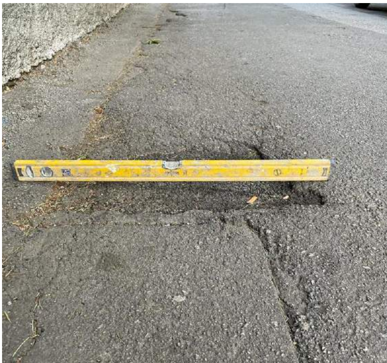
Slika 104: Ulegnuće asfalta (visoki stupanj oštećenja)
