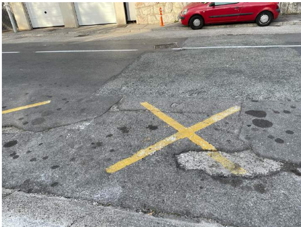
Slika 89: Odlamanje završnog sloja asfalta (visoki stupanj oštećenja)
