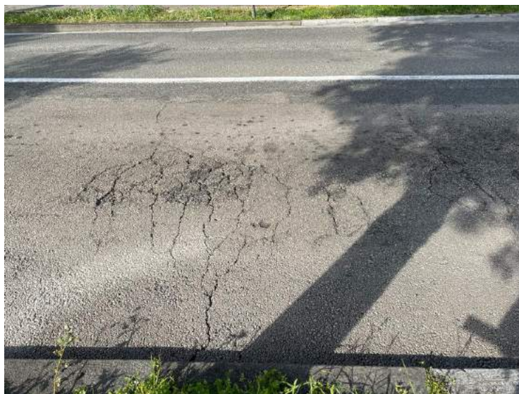
Slika 63: Mrežaste pukotine (visoki stupanj oštećenja)
