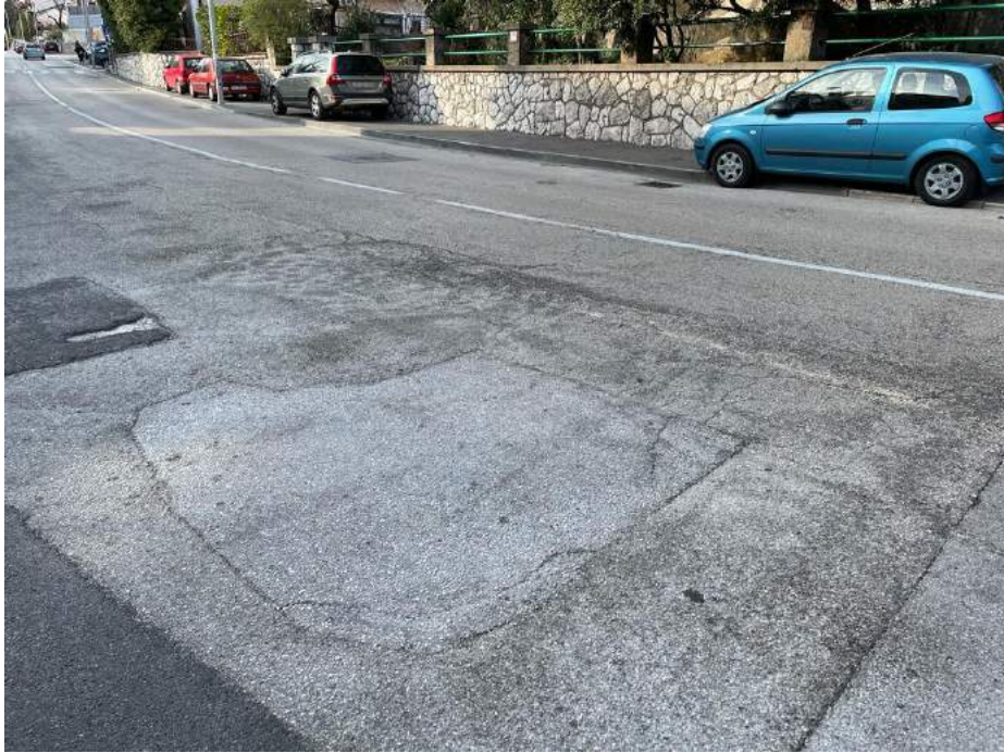
Slika 83: Krunjenje asfalta (visoki stupanj oštećenja)
