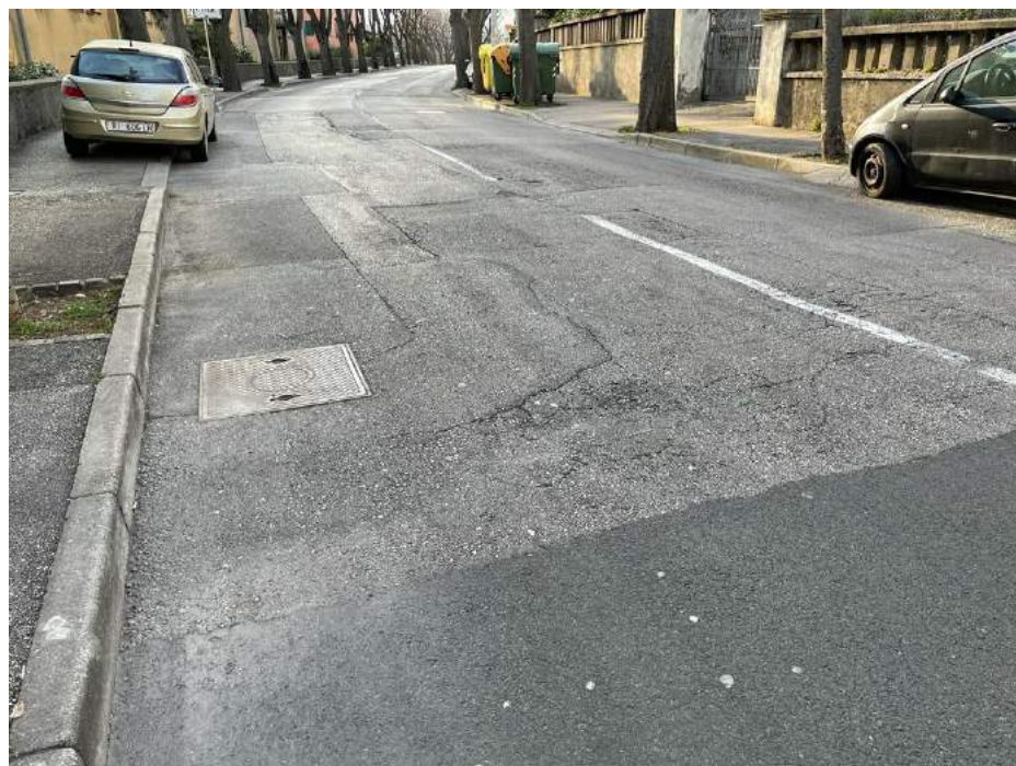
Slika 96: Popravci (visoki stupanj oštećenja)
