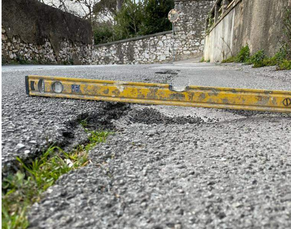
Slika 109: Ulegnuće asfalta (visoki stupanj oštećenja)
