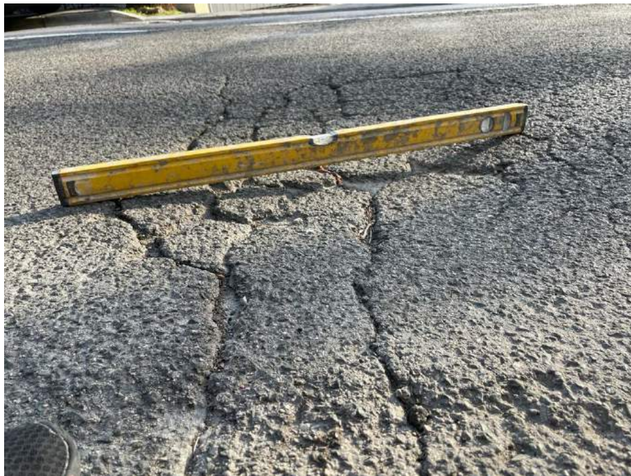
Slika 94: Ulegnuće (visoki stupanj oštećenja)
