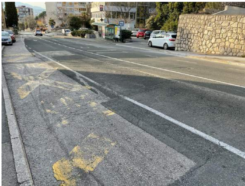
Slika 26: Popravci i mrežaste pukotine (visok stupanj oštećenja)
