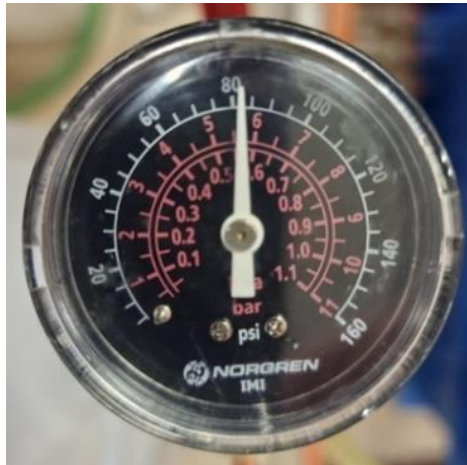
Slika 16. Kontrolni Norgren manometar 0-12 bara.
