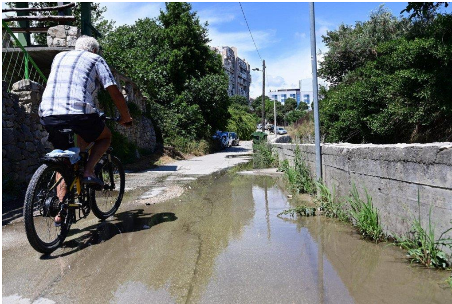
Slika 2.1 Primjer očiglednog gubitka vode – puknuće vodovodne cijevi na Putu Trstenika [10].
