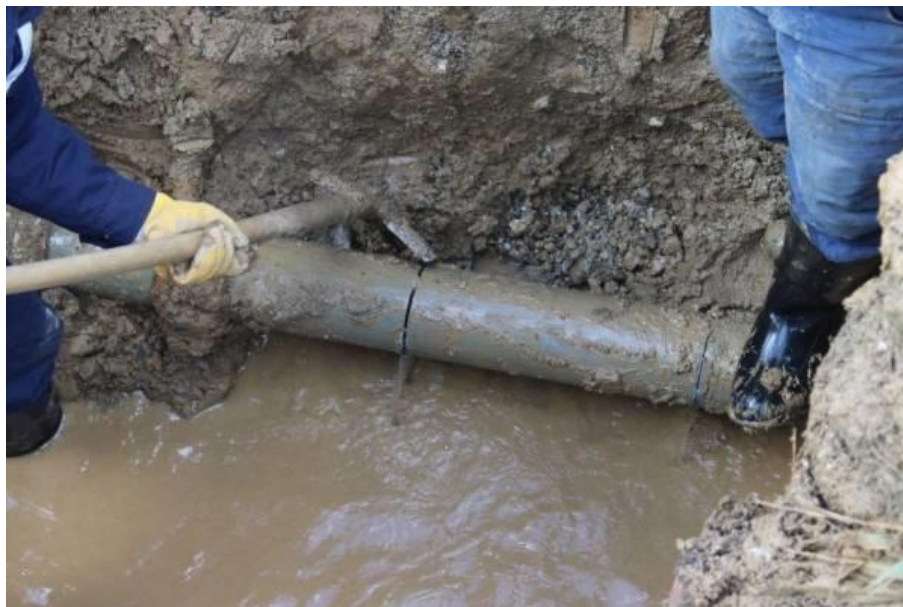
Slika 2.2 Primjer prikrivenog gubitka vode – puknuće vodovodne cijevi u Brestovcu [11].
