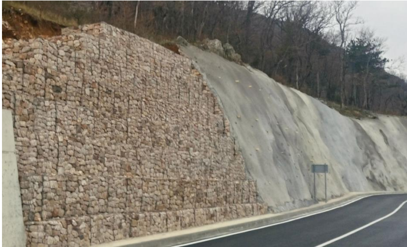
Slika 7. Primjer obložnog zida izvedenog uz prometnicu (foto: Renar d.o.o. i Neuron d.o.o., 2004.)
