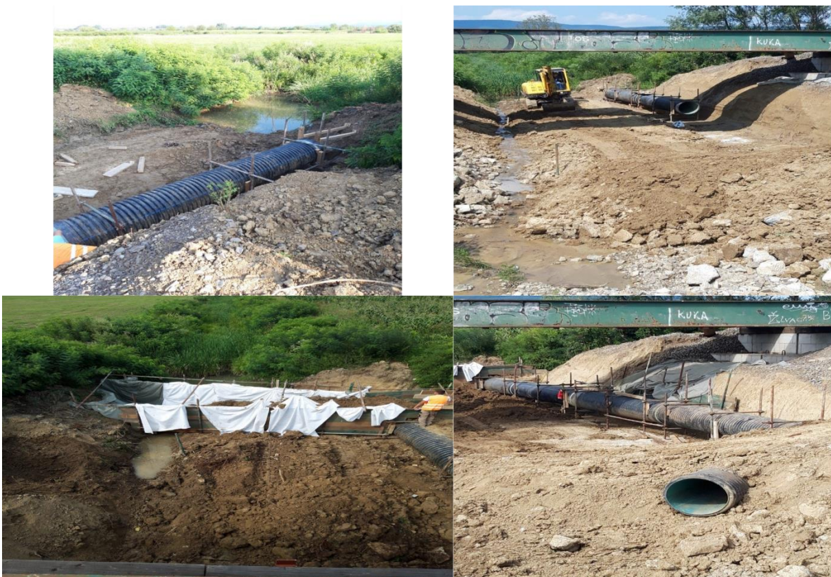
Slika 47. Cijev za odvodnju, Staro Petrovo Selo, Pružne građevine
