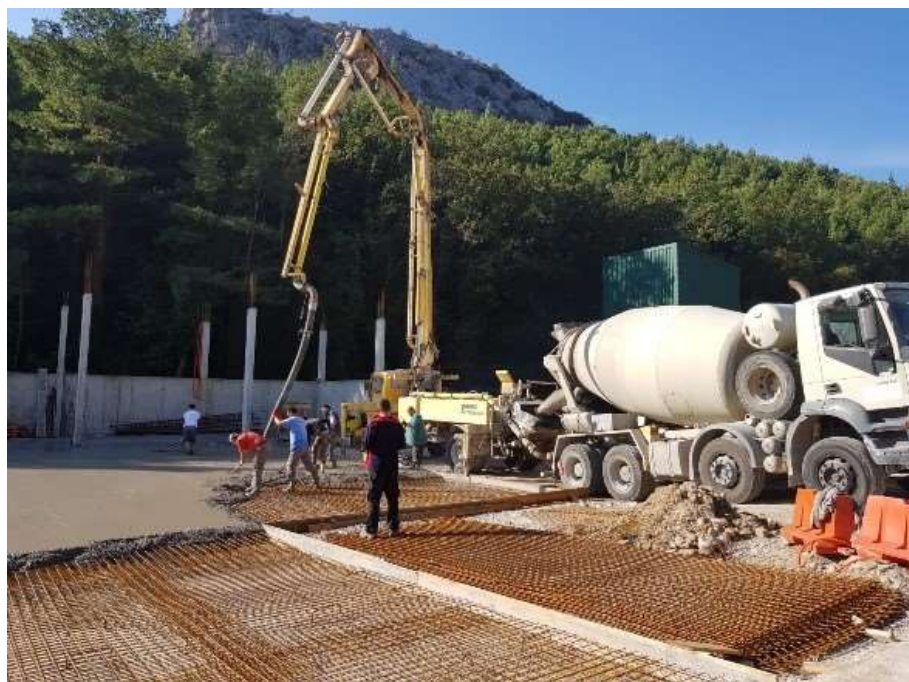
Slika 20. Betoniranje podne ploče manipulativnog prostora( Izvor: Grad Omiš, Upravni odjel za komunalnu i stambenu djelatnost, prostorno uređenje i zaštitu okoliša, pristup rujan 2022.)
