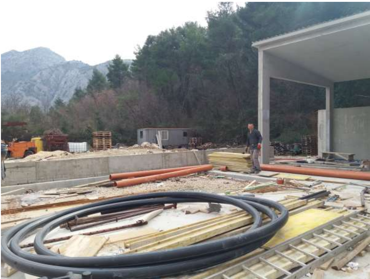
Slika 24. Prikaz vodovodnih i odvodnih cijevu prije polaganja u rovove i sl. ( Izvor: Grad Omiš, Upravni odjel za komunalnu i stambenu djelatnost, prostorno uređenje i zaštitu okoliša, pristup rujun 2022.)
