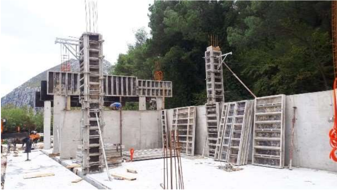
Slika 22. Izrada AB konstrukcije nadstrešnice ( Izvor: Grad Omiš, Upravni odjel za komunalnu i stambenu djelatnost, prostorno uređenje i zaštitu okoliša, pristup rujun 2022.)
