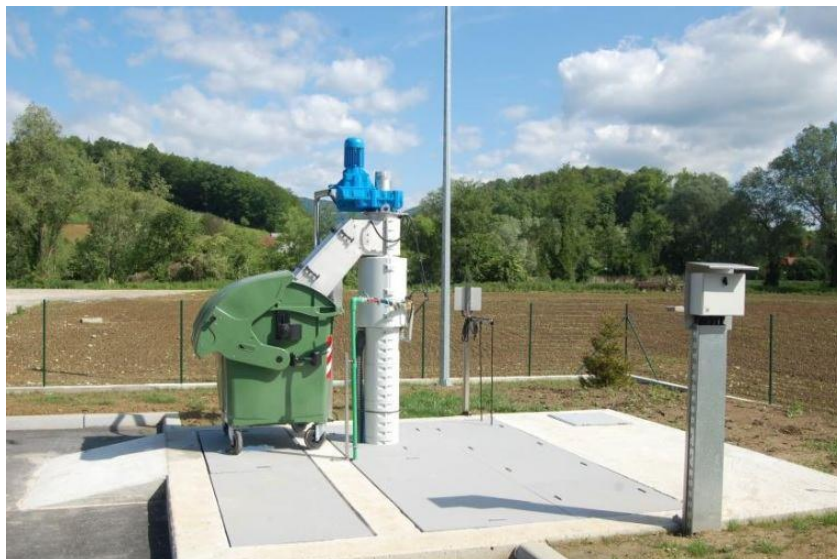
Slika 5: Ulazna crpna stanica
