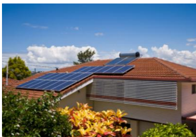
Slika 30. Solarni paneli na krovu kuće
