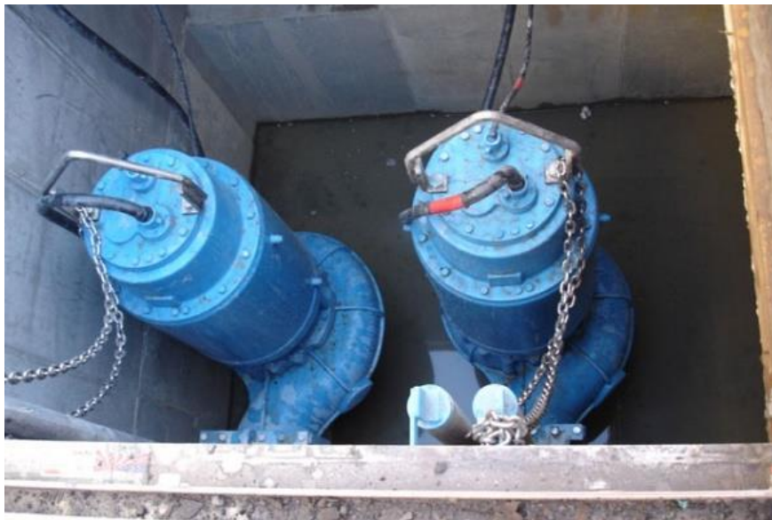
Slika 14 Crpna stanica ukopanog tipa s mokrom izvedbom [3]
