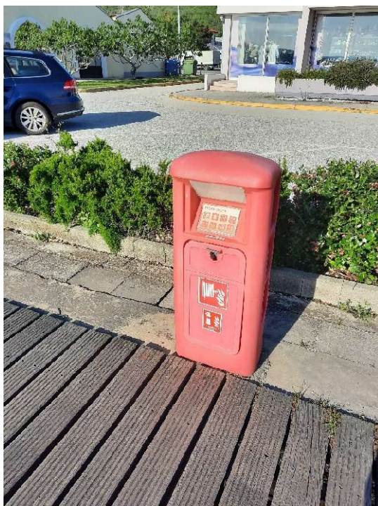
Slika 2: Ormarić za opskrbu pitkom vodom i vatrogasni ormarić, Marina Punat (foto autor)
