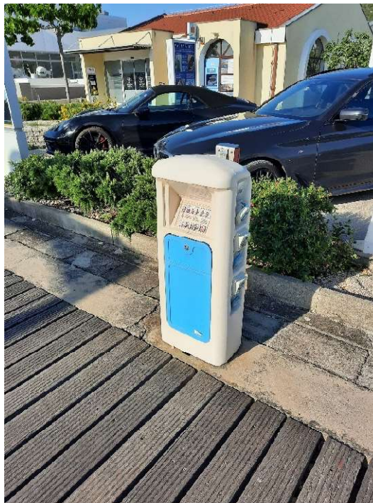
Slika 1: Ormarić za opskrbu električnom energijom, Marina Punat (foto autor)
