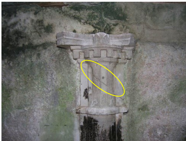
Slika 1. Kapitel stupa s označenom pukotinom
