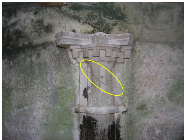
Slika 1. Kapitel stupa s označenom pukotinom
