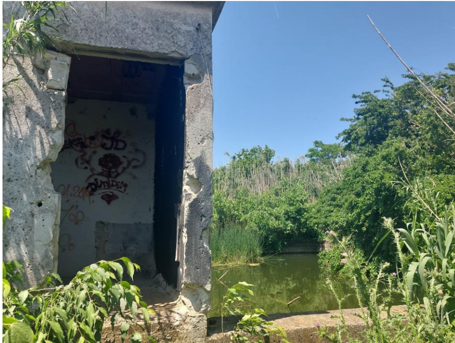
Slika 58: Strojarnica bazena van upotrebe [fotografija: autor, 21.05.2023.]
