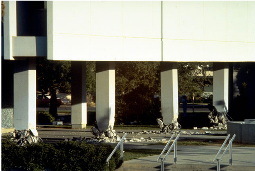
Slika 2.8: Popušteni stupovi na zgradi Imperial County Service, El Centro, Kalifornija 1979. god. [8]
