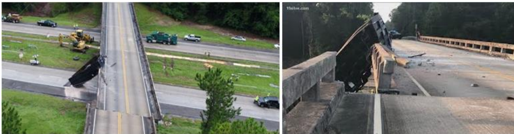
Slika 2: Pomak mosta nakon udara kamiona [3]
