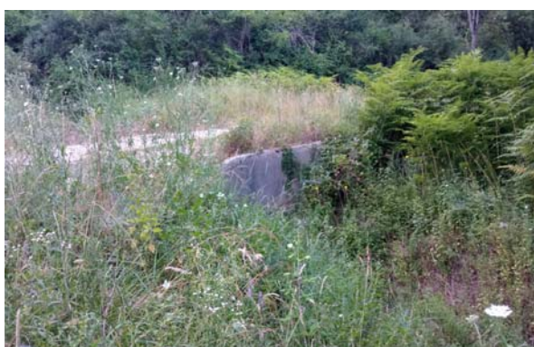
Slika 69. cestovni propust (pr1)
