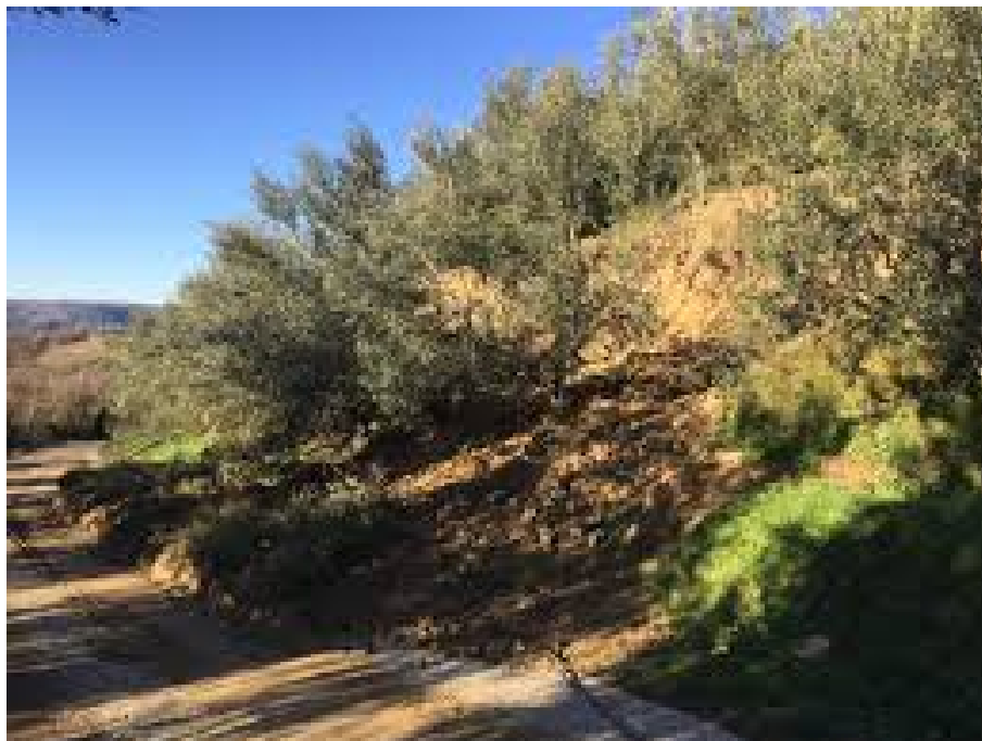
Slika 2.9: Klizište u selu Flegi, općina Motovun [4]
