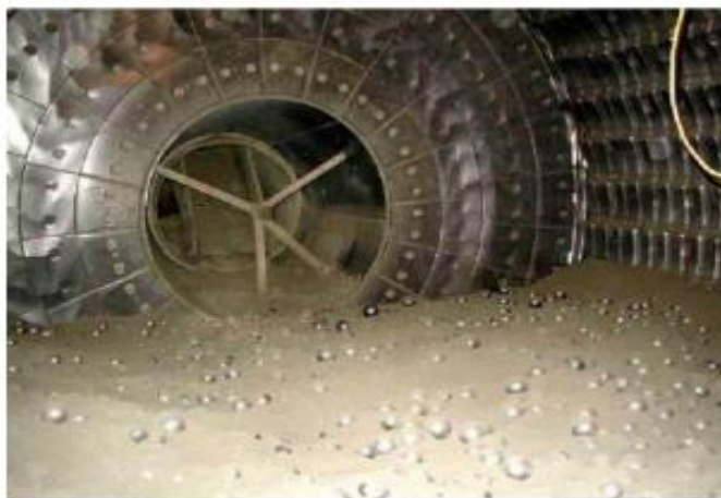
Slika 4. Mljevenje klinkera, unutrašnjost mlina s kuglama [1]
