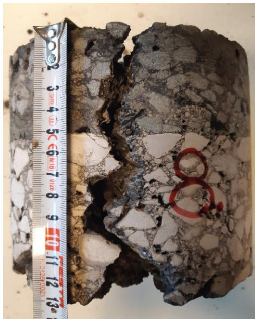
Slika 3: Uzorak jezgre asfaltnog zastora kod poprečne pukotine
