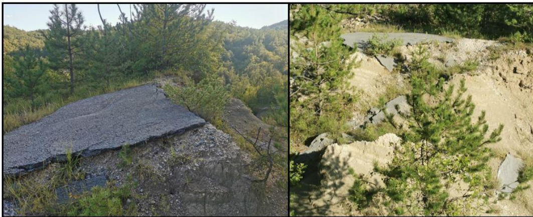
Slika 16 Ostaci lokalne ceste (foto: L.Vuksan, kolovoz 2023)
