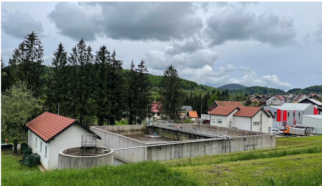
Slika 6. Uređaj za pročišćavanje otpadnih voda Delnice (vlastita fotografija)
