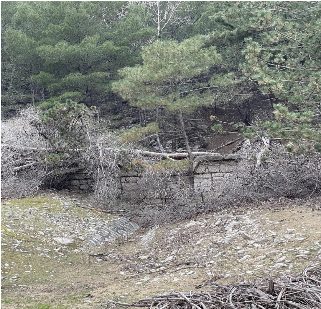
Slika 11: Poprečni objekt za zadržavanje nanosa (gabion). (Slika autora 18.04.2022.)
