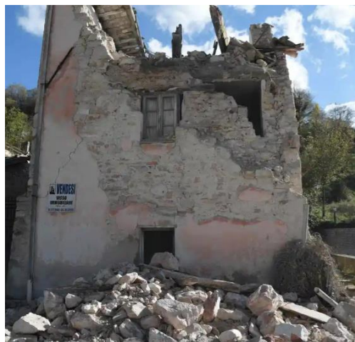
Slika 9. Djelomično prevrtanja zida nakon potresa u Italiji [15]
