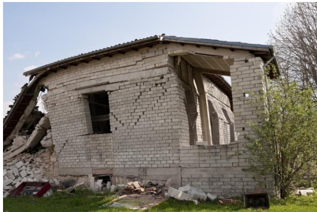
Slika 16. Otkazivanje zida u ravnini [10]
