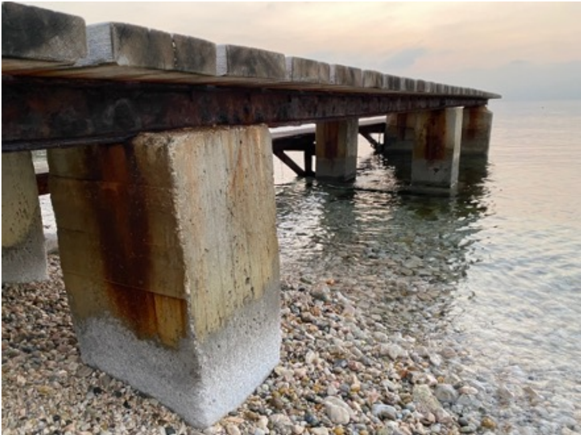
Slika 4: Betonski stupovi zahvaćeni korozijom – Kostrena, (izvor: vlastita fotografija)
