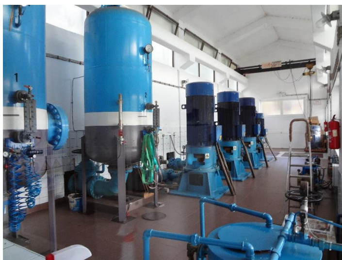
Slika 2.10. Unutrašnjost crpne stanice na Vranskom jezeru na Cresu (izradio autor)
