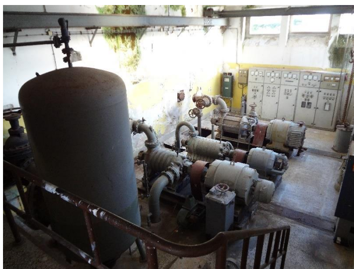
Slika 2.8. Unutrašnjost stare crpne stanice (izradio autor)
