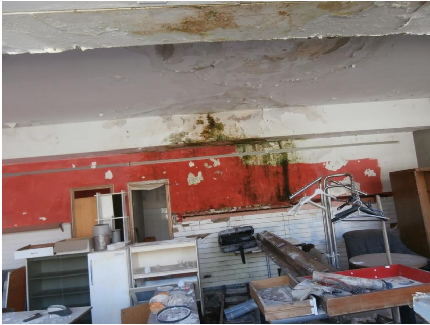
Slika 24 Na suterenskoj etaži vidljivo kako voda prodire kroz ploču te dolazi do opadanja žbuke [13]
