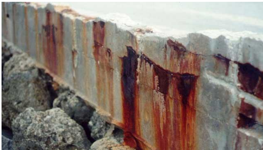
Slika 11 Pukotine uslijed korozije armature [14]
