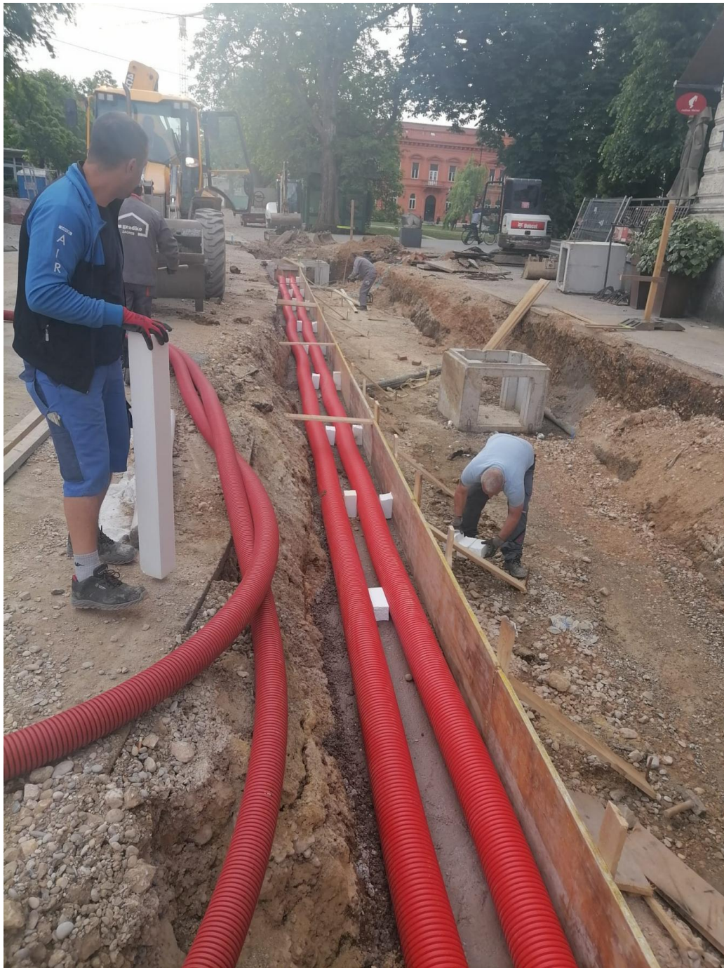
Slika 13: Primjer postavljanja rebraste cijevi za kabelsku kanalizaciju iz rekonstrukcije Zvijezde 3 (foto autor)
