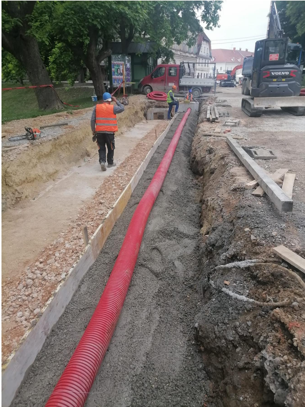
Slika 12: Primjer postavljanja rebraste cijevi za kabelsku kanalizaciju iz rekonstrukcije Zvijezde 2 (foto autor)
