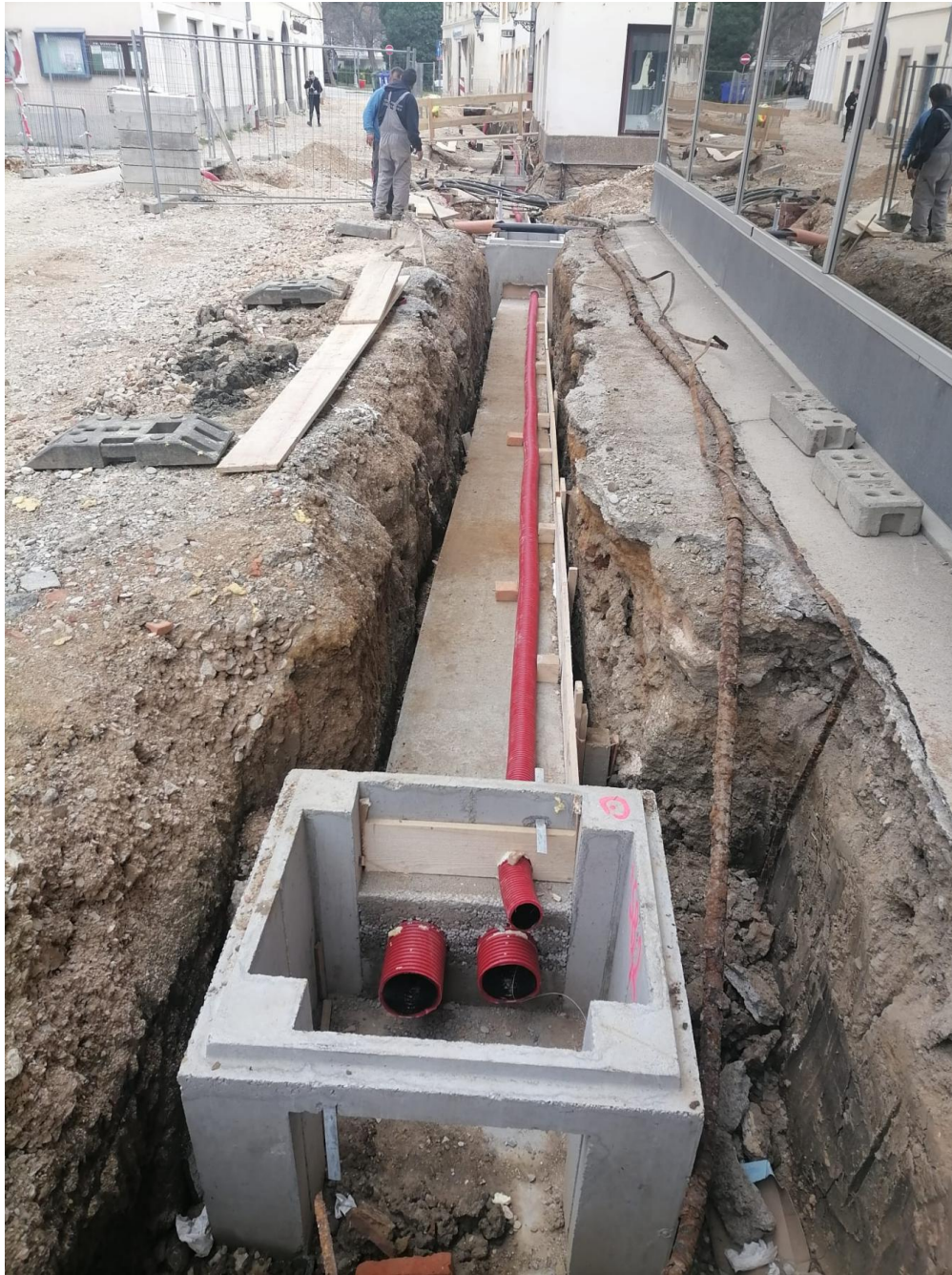
Slika 15: Prikaz rebraste cijevi u betonu (foto autor)
