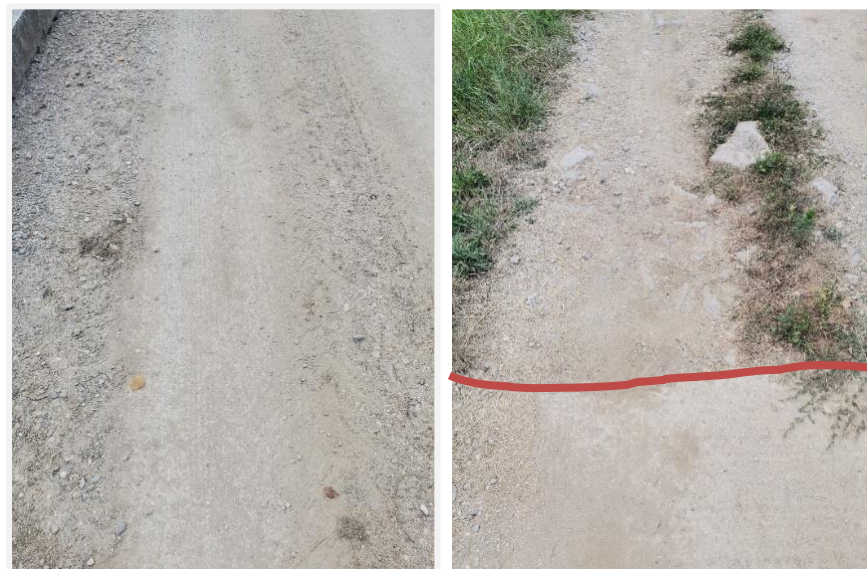
Slika 61: Prikaz gazne površine Mosta D te razlika u gaznim površinama mosta i prilazne staze
