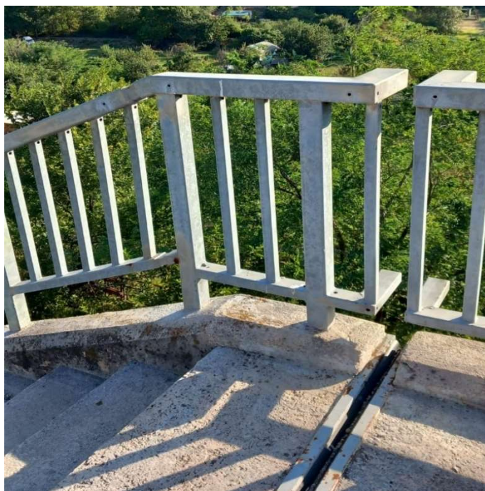
Slika 94: Prekid ograde i rukohvata [autorica]
