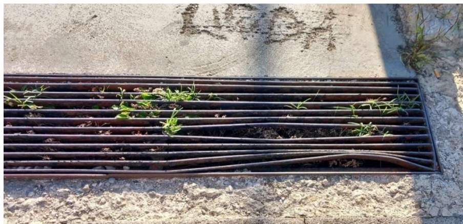
Slika 84: Detalj oštećenja hodne plohe i rešetke [autorica]
