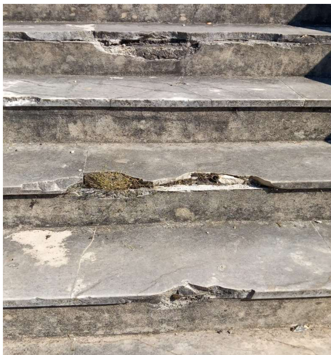
Slika 77: Detalj oštećenja nastupnih ploha stuba [autorica]
