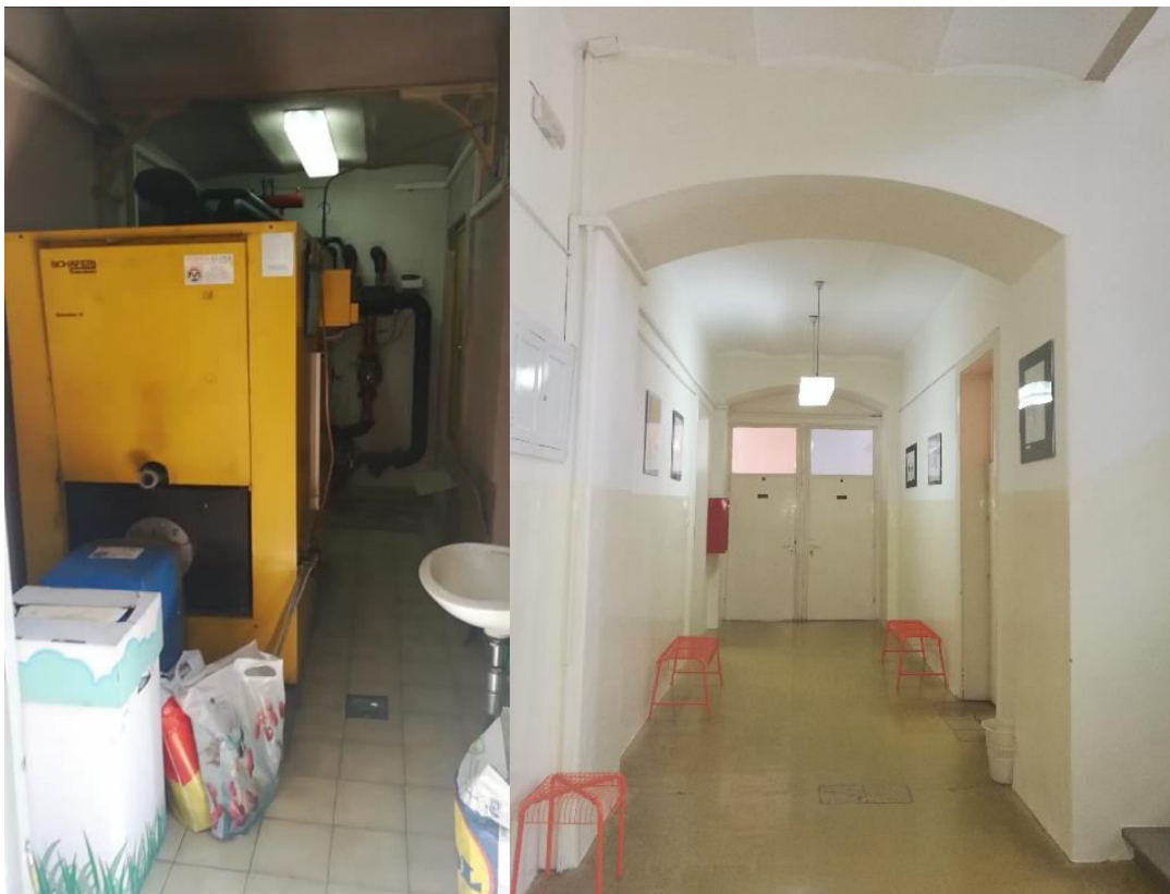
Slika 61. Kotlovnica (lijevo); Slika 62. Hodnik prvog kata (desno)
