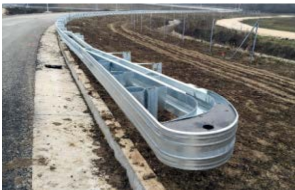
Slika 89. Počeci/završeci zaštitne odbojne ograde
