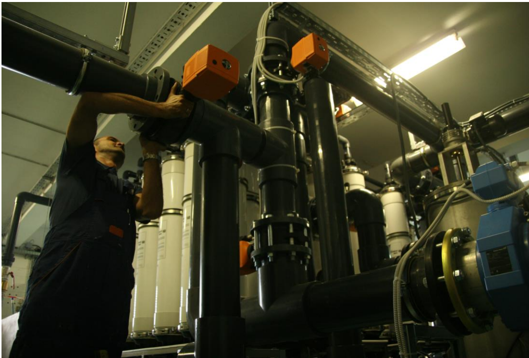
Slika 41. Radovi održavanja membranskog filtera (Rac, 2019.)
