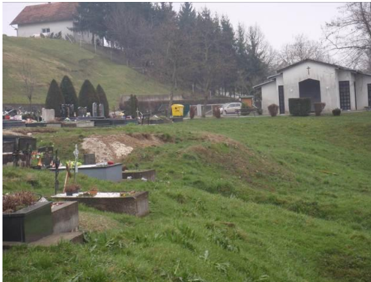
Slika 22. Klizište 1 aktivirano 4. travnja 2013. godine (fotografirano 4.3.2014) – pogled na gornji dio klizišta i oštećene grobove (preuzeto iz Mihalić Arbanas i dr., 2014).
