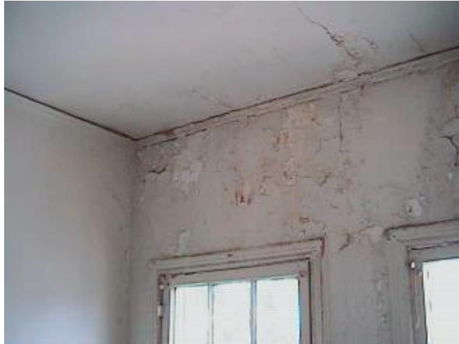
Slika 6: Ljuštenje i oštećenje žbuke [5]
