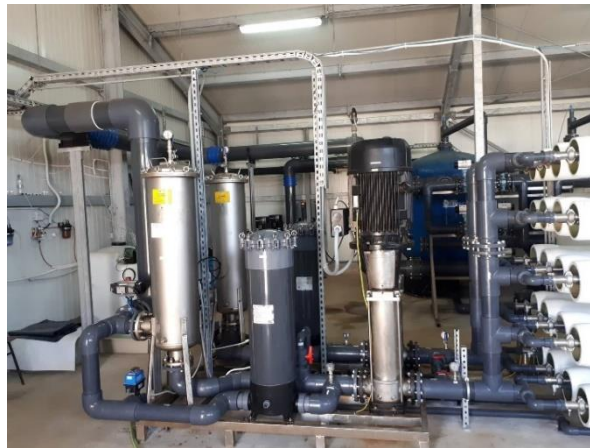
Slika 21: Postrojenje za desalinizaciju bočate vode [25]
