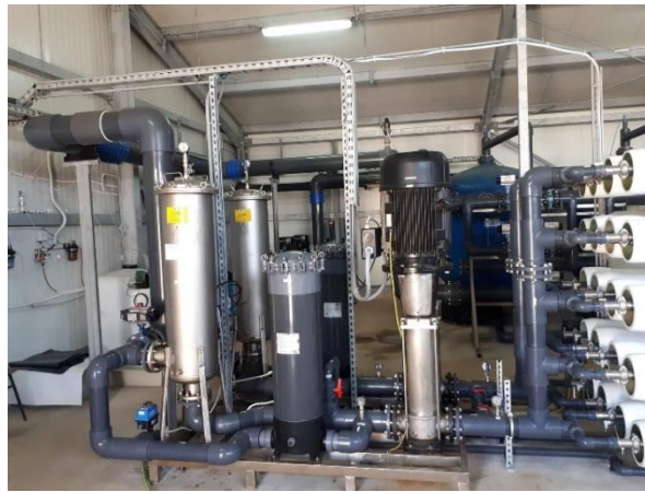
Slika 21: Postrojenje za desalinizaciju bočate vode [25]
