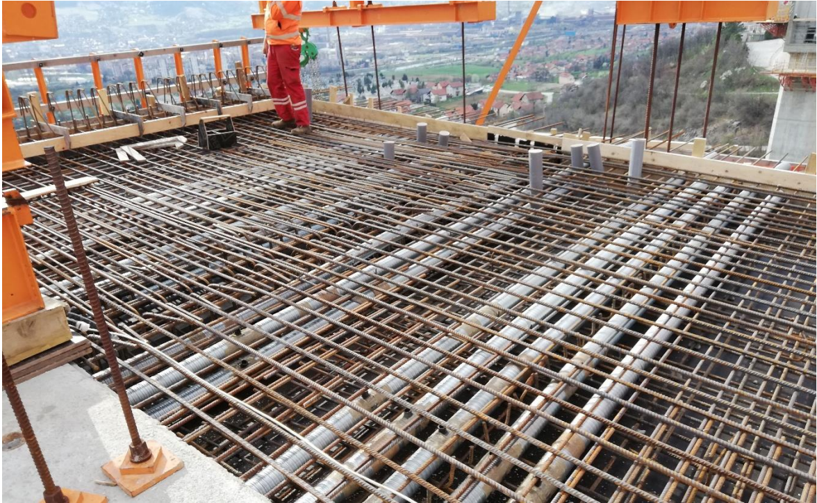
Slika 36: Armiranje gornje ploče rasponske konstrukcije i postavljanje cijevi za prednapinjanje (autor: Kenan Zaimović)
