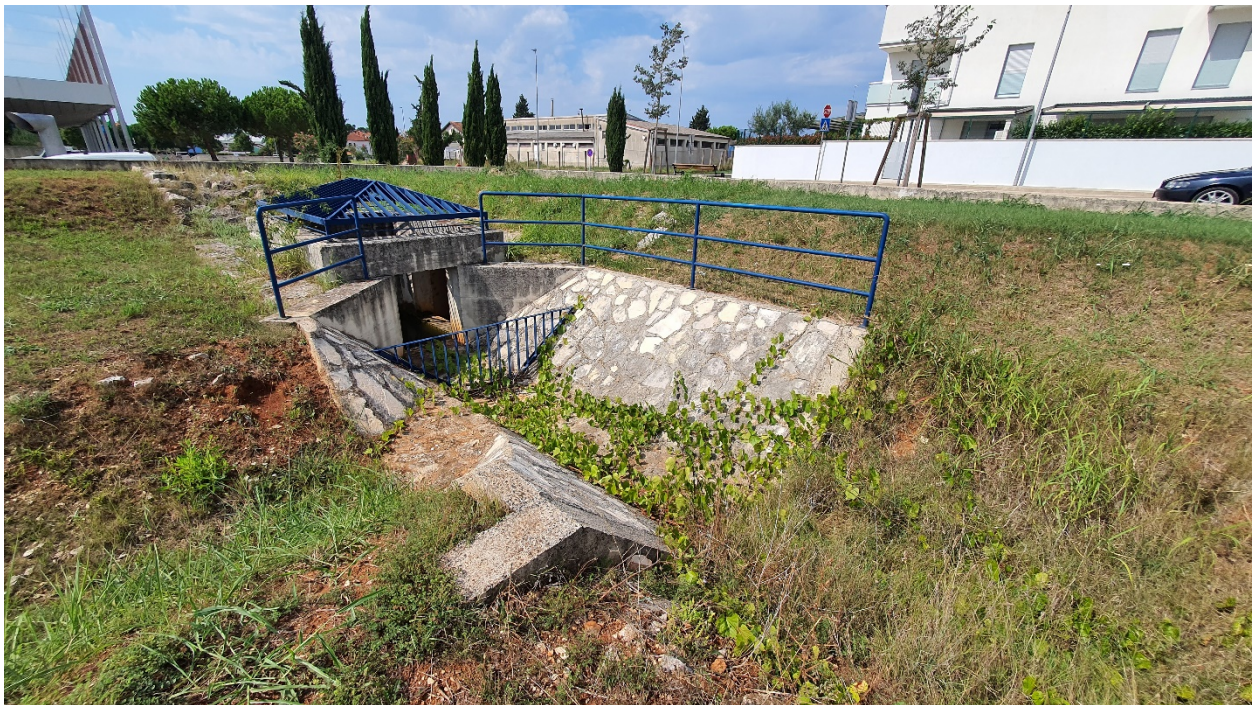
Slika 13. Kolektor oborinskih voda u blizini dvorane
