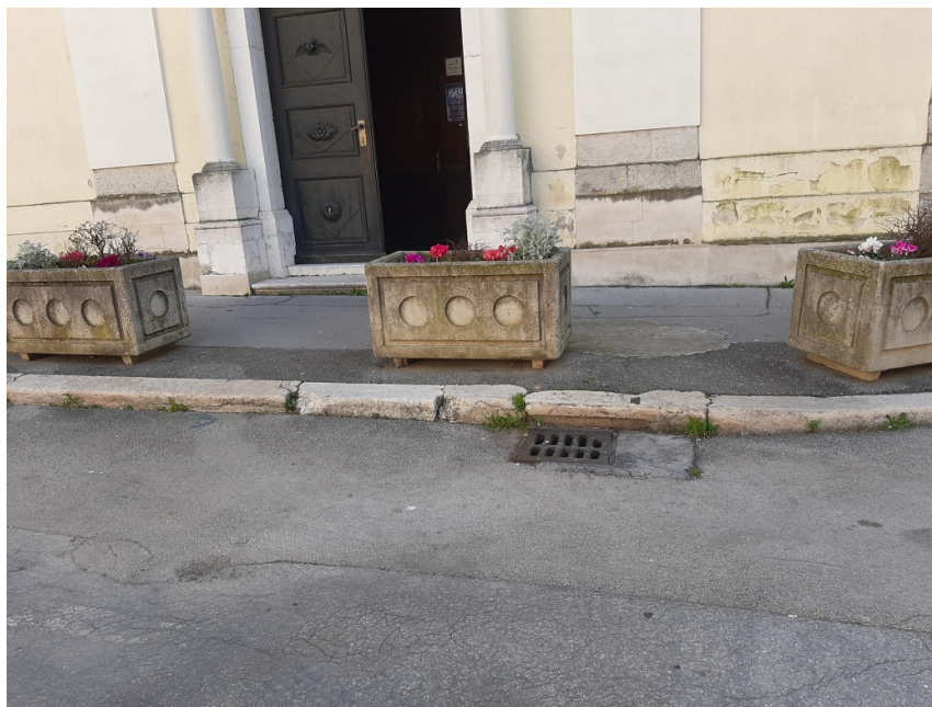
Slika 125: Šaht za odvodnju oborinske vode ispred crkve sv. Jeronima.
