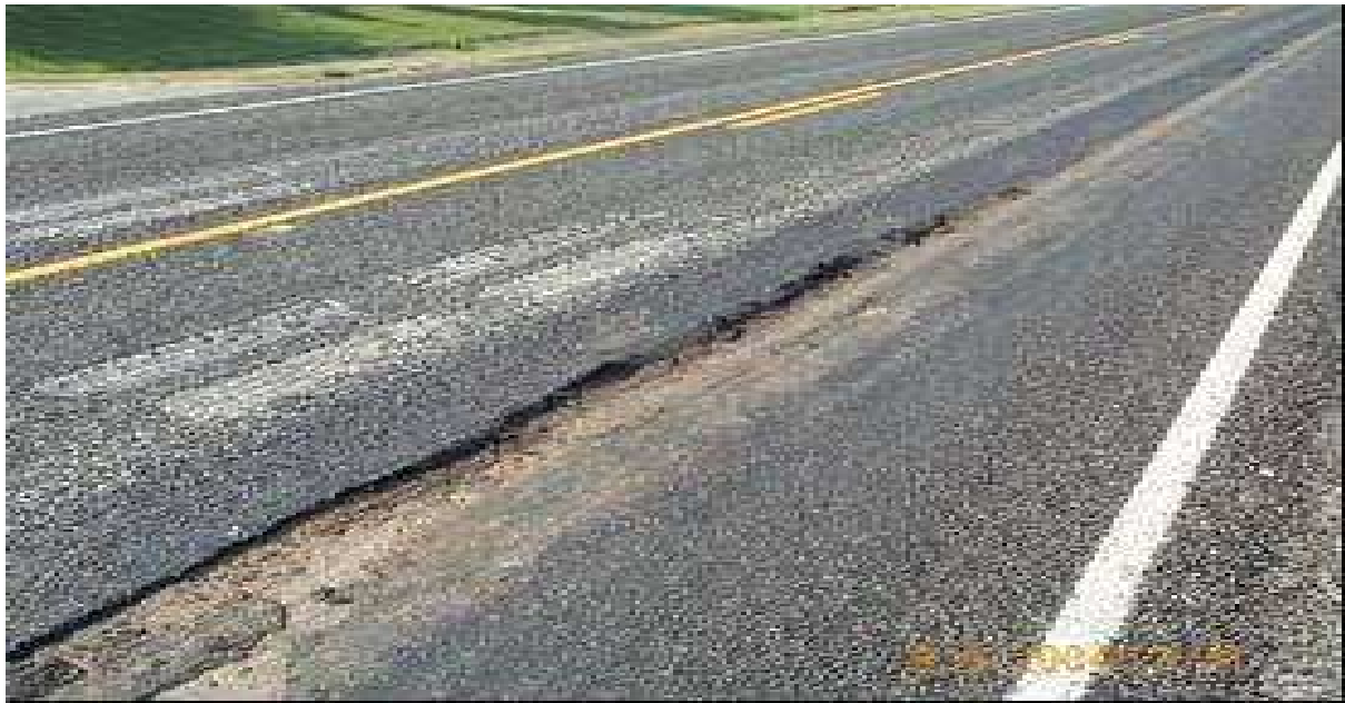
Slika 6. Oštećenje kolnika u obliku kolotruga [10]
