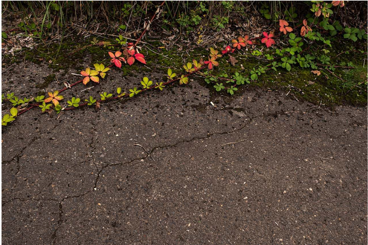
Slika 11. Oštećenje ruba kolnika zbog loše odvodnje [11]
