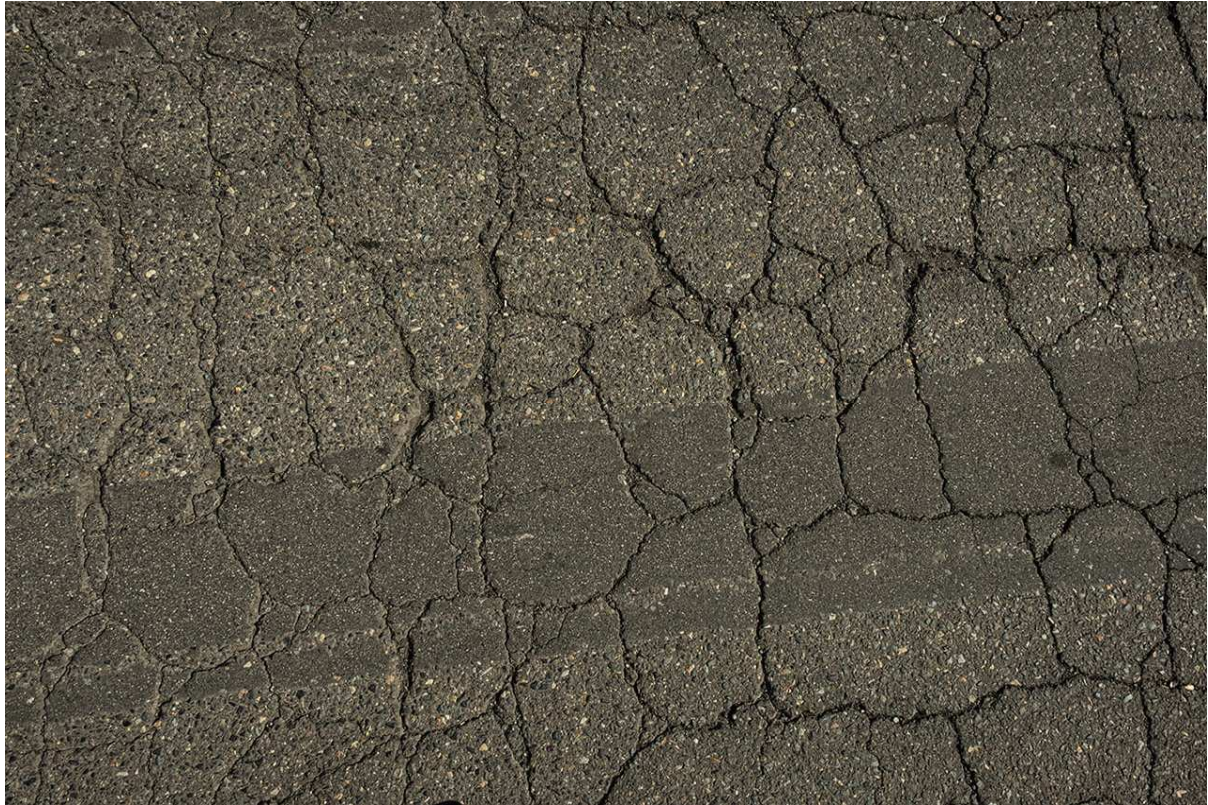
Slika 7. Oštećenje kolnika nepravilnog uzorka[11]
