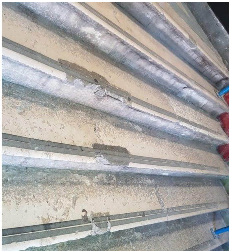
Slika 68. Oštećenje stubišta prizemlja (Foto: autor)
