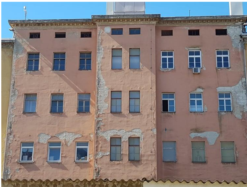
Slika 67. Oštećenje sjevernog pročelja (Foto: autor)
