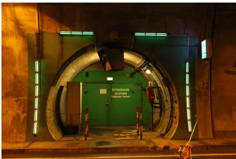
Slika 27: Izlaz za slučaj nužde u tunelu [28]
