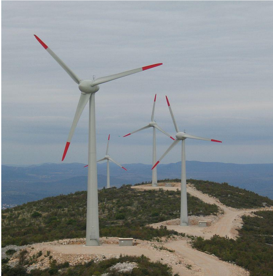
Slika 38. Visinska vjetroelektrana Trtar-Krtolin
