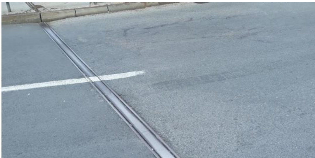
Slika 27: Prijelazna naprava na kraju mosta
