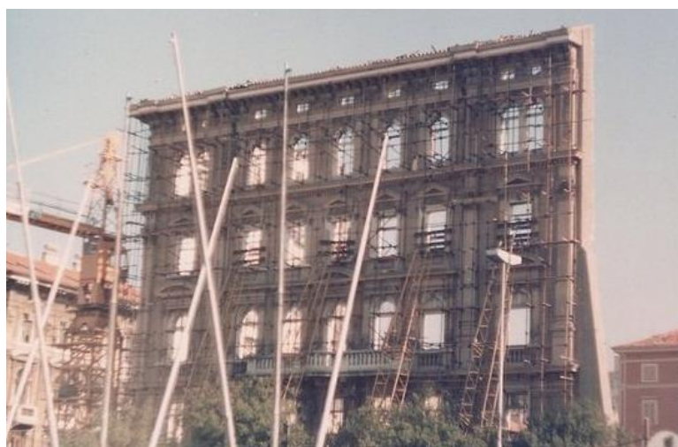
Slika 26: Pridržavanje fasadnog zida palače Mučović-Rinaldi [10]
