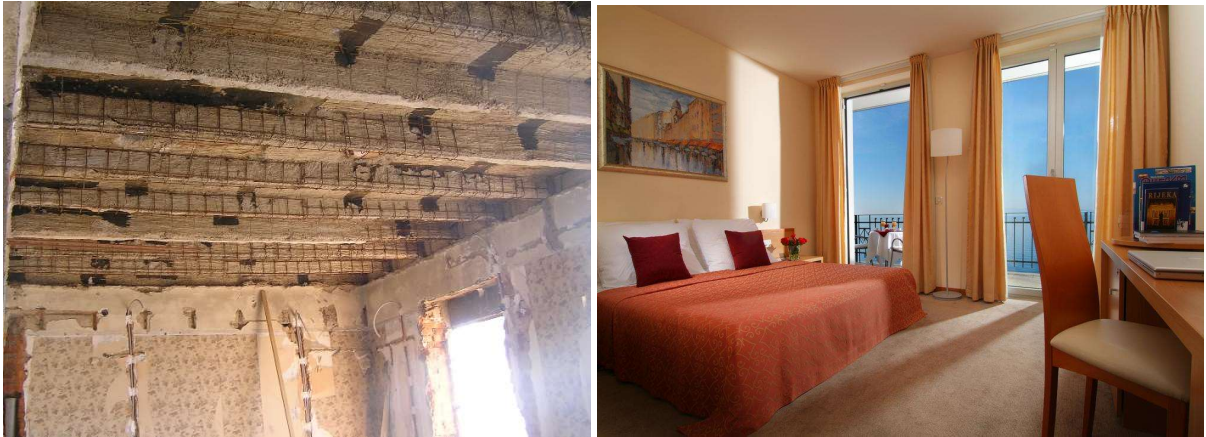
Slika 59: Soba hotela Jadran tijekom (lijevo) i nakon rekonstrukcije (desno) (izvori: Fotodokumentacija izvođenja radova na hotelu Jadran, vlasništvo "Studia Remik" d.o.o., 2004./2005. godina, Rijeka i internet stranica hotela Jadran https://www.jadran-hoteli.hr/jadran , pristup 09.05.2021.)
